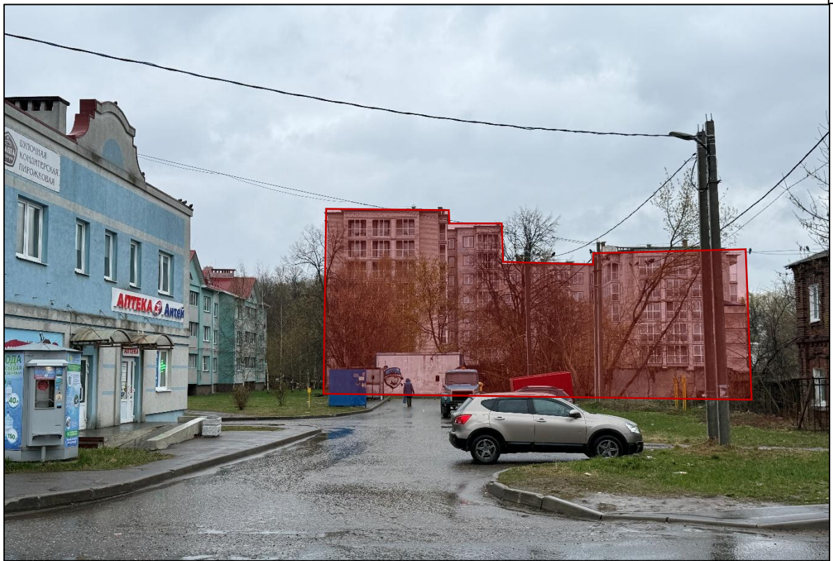
Рисунок 16: Возводимый многоквартирный жилой дом по адресу: Ивановская область, г. Иваново, ул. Володиной, д. 8 А, вид улицы Дальний тупик
