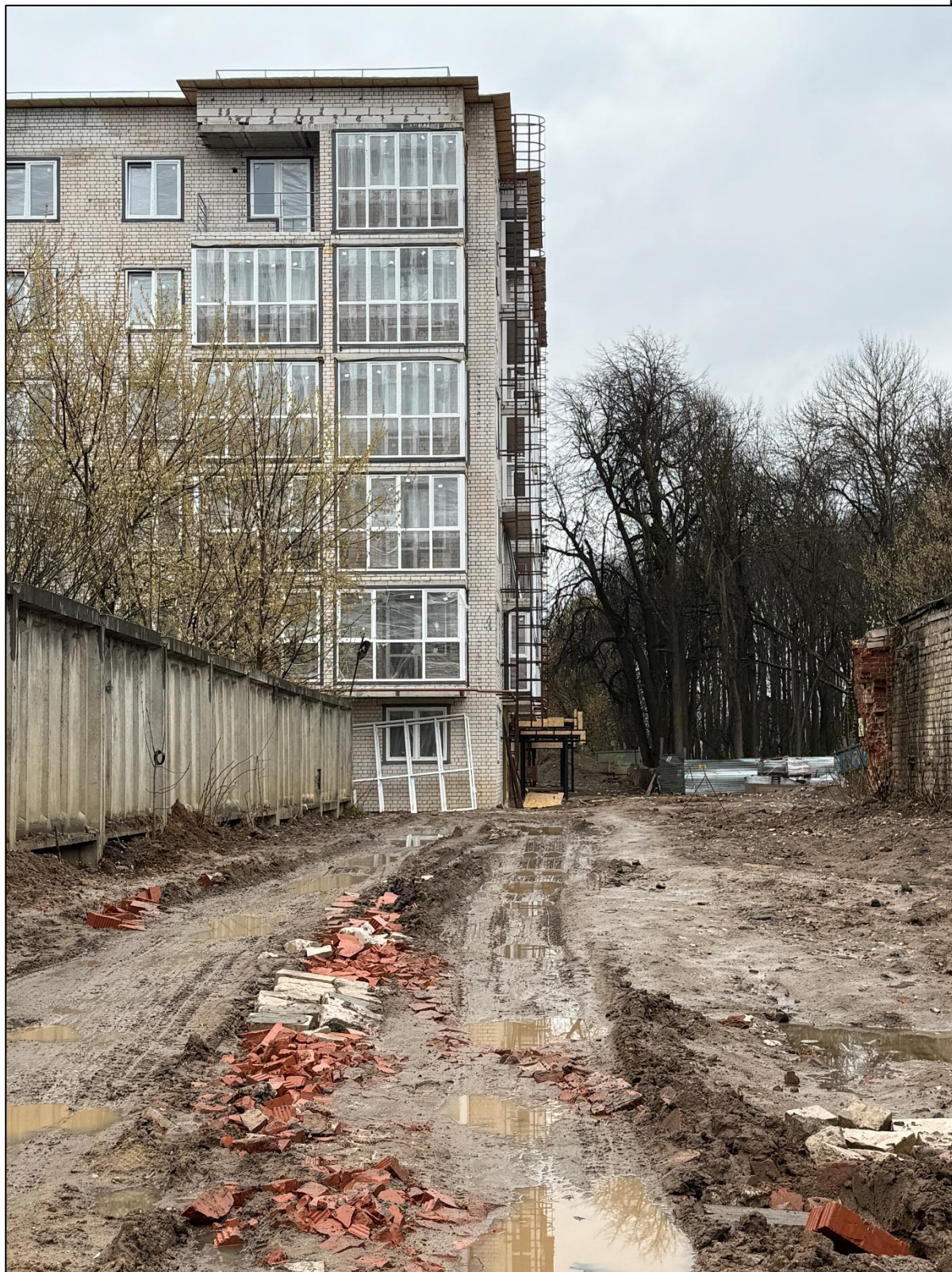
Рисунок 19: Возводимый многоквартирный жилой дом по адресу: Ивановская область, г. Иваново, ул. Володиной, д. 8 А
