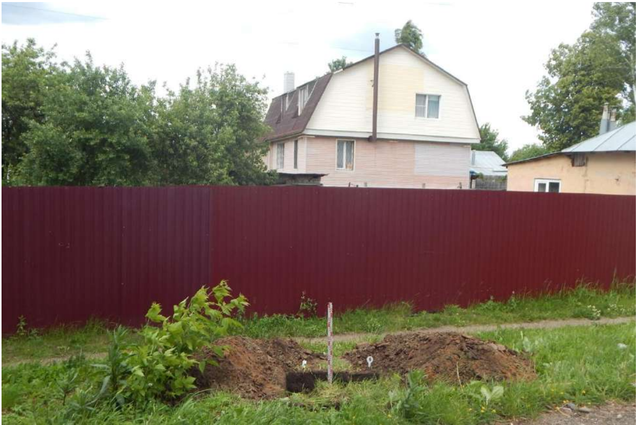
Рис. 54. Иваново, между ул. Кирпичной и ул. Некрасова. Общий вид с юга выкопанного шурфа № 6.
