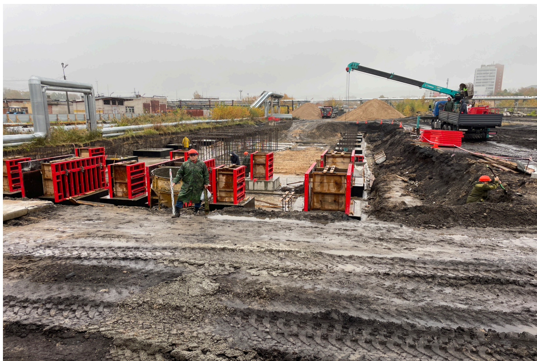
Рис. 12. Объект: «Строительство водогрейной котельной 400Гкал/час на территории Ивановской ТЭЦ-2», расположенной по адресу: РФ, Ивановская обл., г. Иваново, ул. Суворова, 76. Вид из тф 1 на В.
