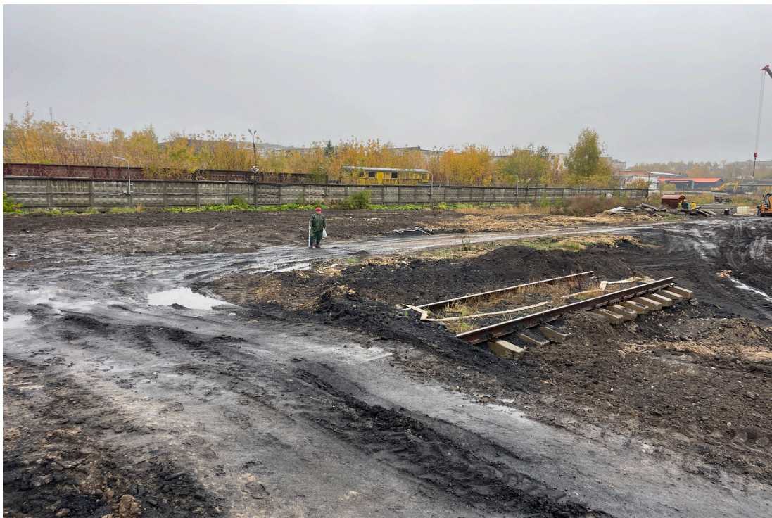
Рис. 14. Объект: «Строительство водогрейной котельной 400Гкал/час на территории Ивановской ТЭЦ-2», расположенной по адресу: РФ, Ивановская обл., г. Иваново, ул. Суворова, 76. Вид из тф 3 на СЗ.
