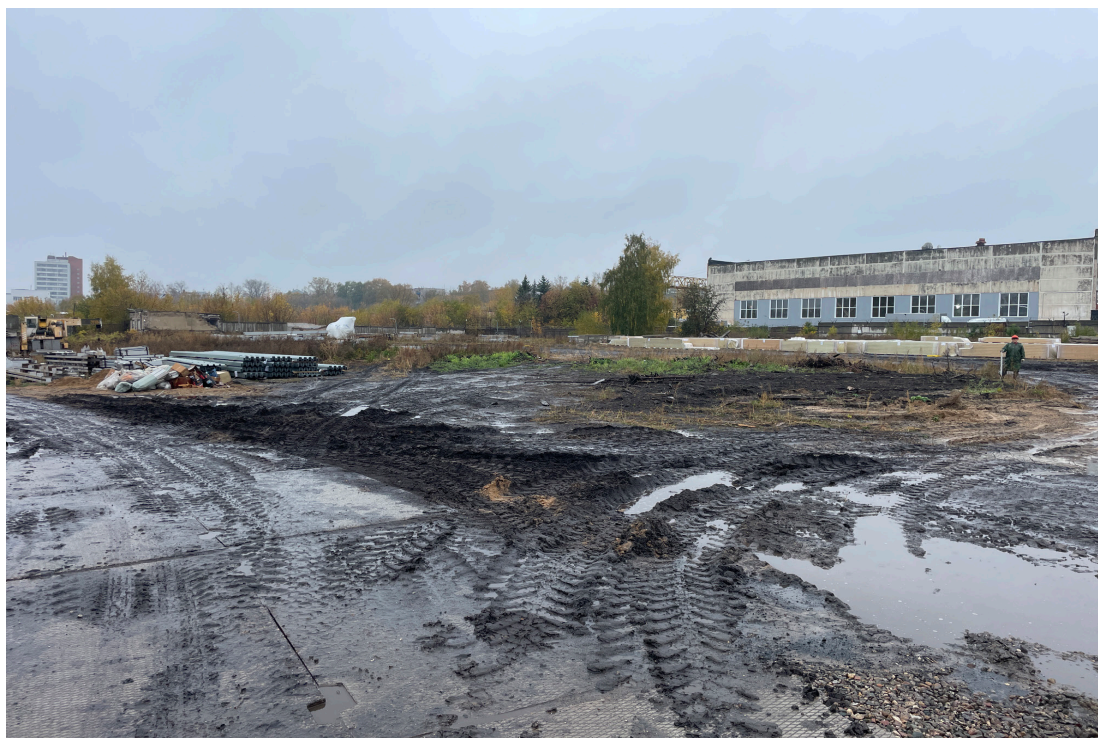
Рис. 18. Объект: «Строительство водогрейной котельной 400Гкал/час на территории Ивановской ТЭЦ-2», расположенной по адресу: РФ, Ивановская обл., г. Иваново, ул. Суворова, 76. Вид из тф 4 на ЮЗ.
