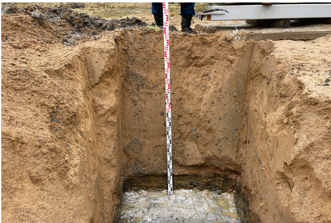
Рис. 29. Объект: «Строительство водогрейной котельной 400Гкал/час на территории Ивановской ТЭЦ-2», расположенной по адресу: РФ, Ивановская обл., г. Иваново, ул. Суворова, 76. Вид с В на стенку шурфа 2.
