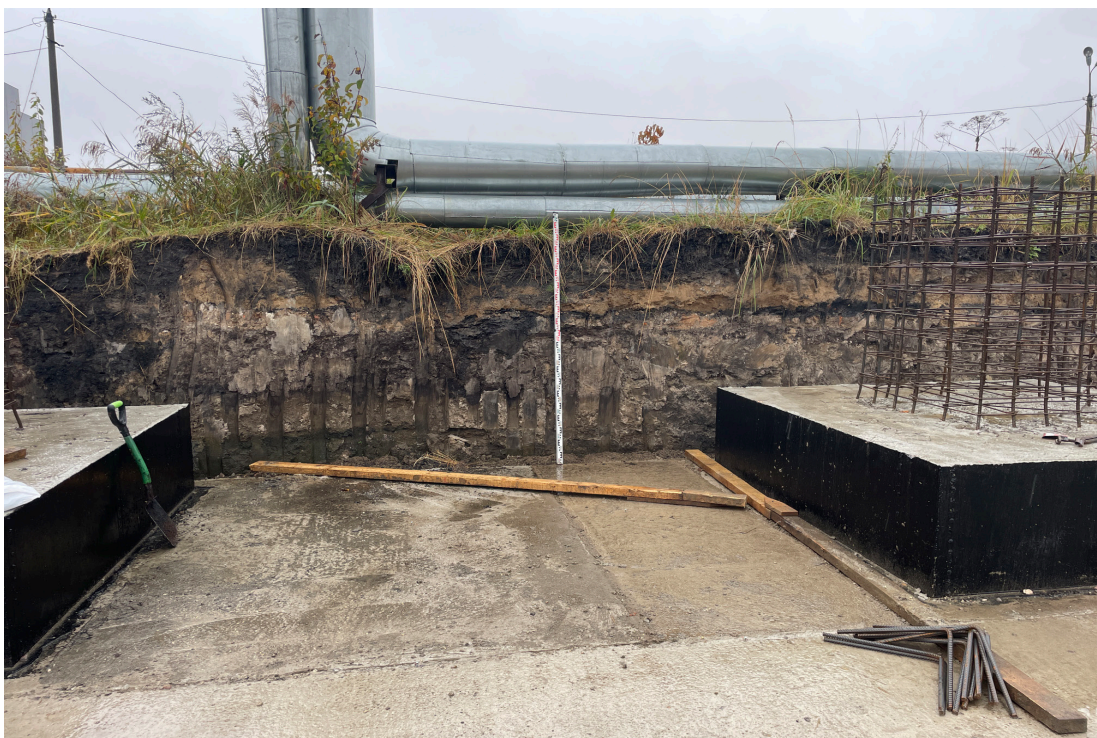
Рис. 42. Объект: «Строительство водогрейной котельной 400Гкал/час на территории Ивановской ТЭЦ-2», расположенной по адресу: РФ, Ивановская обл., г. Иваново, ул. Суворова, 76. Вид с 3 на место зачистки восточного борта строительного котлована.
