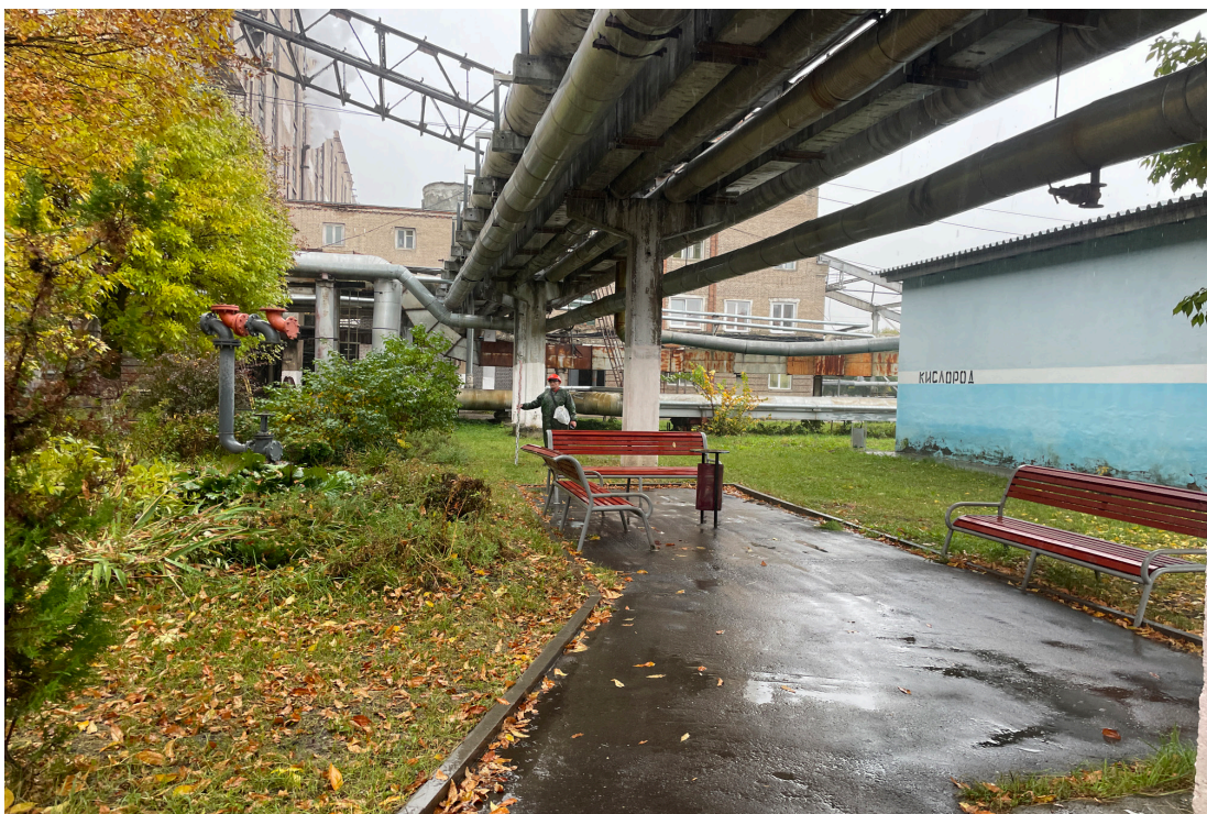
Рис. 23. Объект: «Строительство водогрейной котельной 400Гкал/час на территории Ивановской ТЭЦ-2», расположенной по адресу: РФ, Ивановская обл., г. Иваново, ул. Суворова, 76. Вид из тф 6 на Ю.
