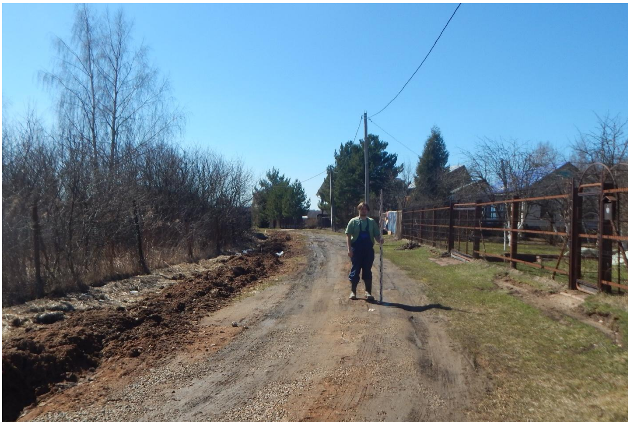
Рис. 163. Ивановская область, Ивановский район, д. Каликино, распределительный газопровод. Общий вид с северо-востока. Точка фотофиксации 5.
