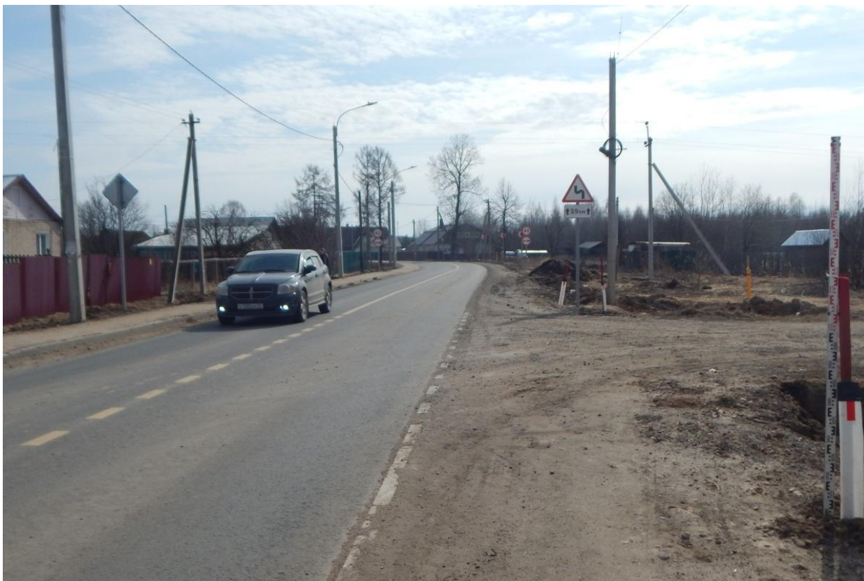
Рис. 43. Ивановская область, Ивановский район, с. Озёрный, распределительный газопровод. Общий вид с северо-запада. Точка фотофиксации 4.
