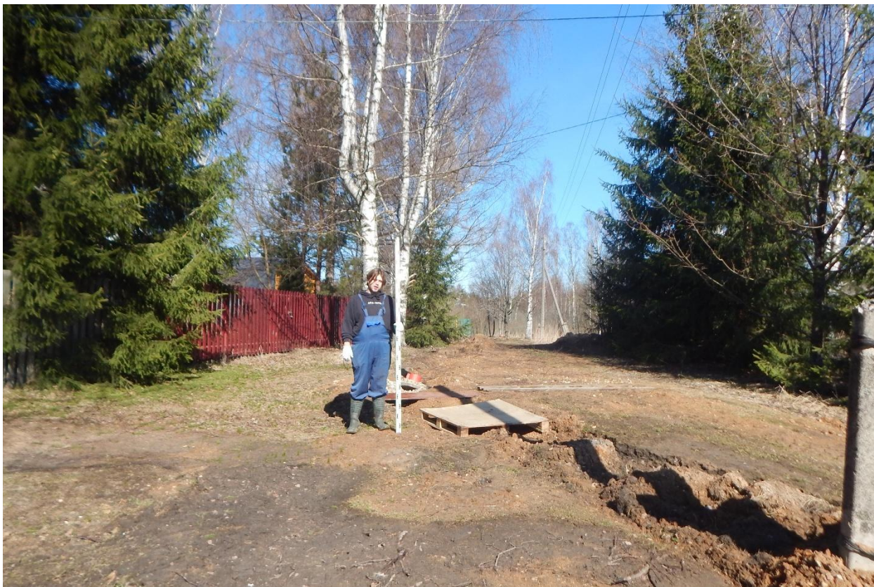
Рис. 157. Ивановская область, Ивановский район, д. Каликино, распределительный газопровод. Общий вид с северо-востока. Точка фотофиксации 2.
