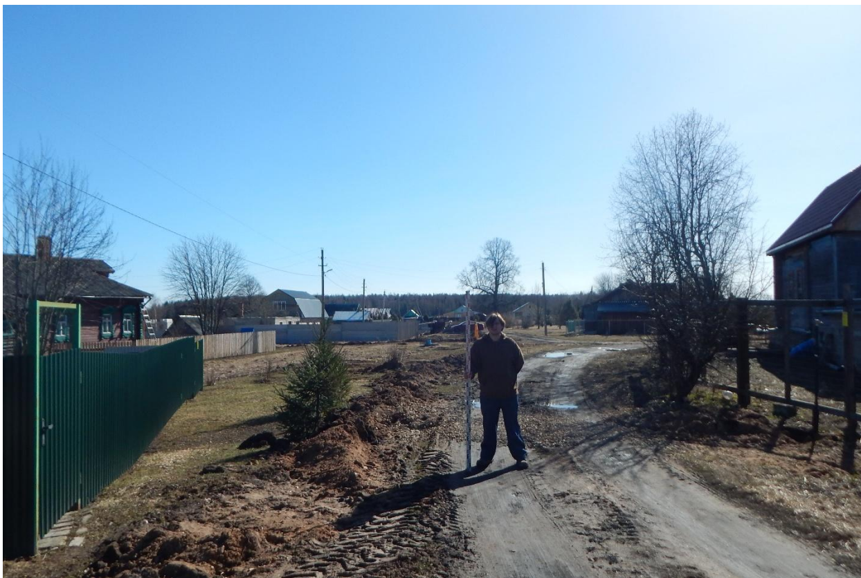
Рис. 212. Ивановская область, Ивановский район, д. Максаки, распределительный газопровод. Общий вид с севера. Точка фотофиксации 4.
