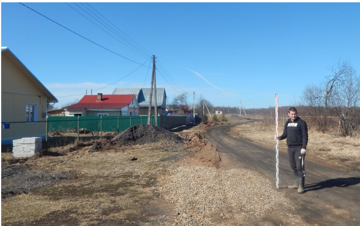
Рис. 205. Ивановская область, Ивановский район, д. Максаки, распределительный газопровод. Общий вид с востока. Точка фотофиксации 1.
