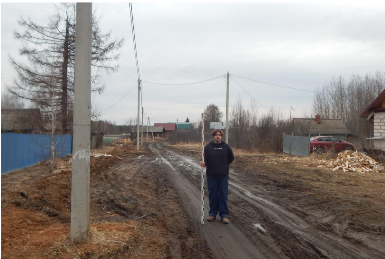
Рис. 52. Ивановская область, Ивановский район, с. Озёрный, распределительный газопровод. Общий вид с юго-юго-востока. Точка фотофиксации 8.
