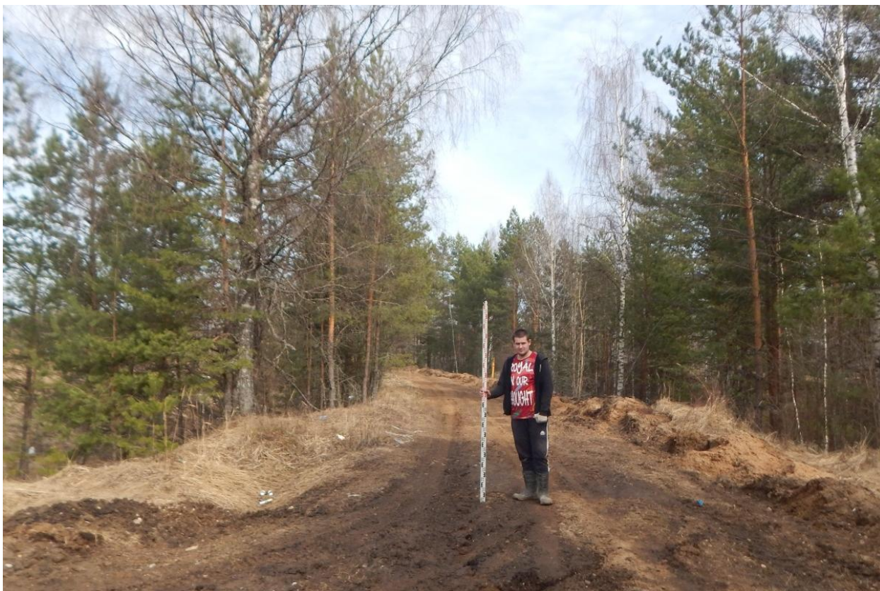
Рис. 45. Ивановская область, Ивановский район, с. Озёрный, распределительный газопровод. Общий вид с юго-запада. Точка фотофиксации 5.
