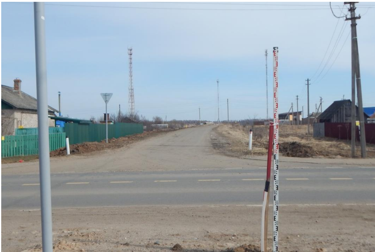
Рис. 42. Ивановская область, Ивановский район, с. Озёрный, распределительный газопровод. Общий вид с юго-запада. Точка фотофиксации 4.
