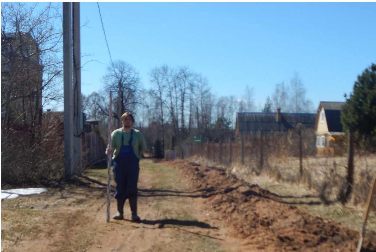
Рис. 160. Ивановская область, Ивановский район, д. Каликино, распределительный газопровод. Общий вид с северо-востока. Точка фотофиксации 3.
