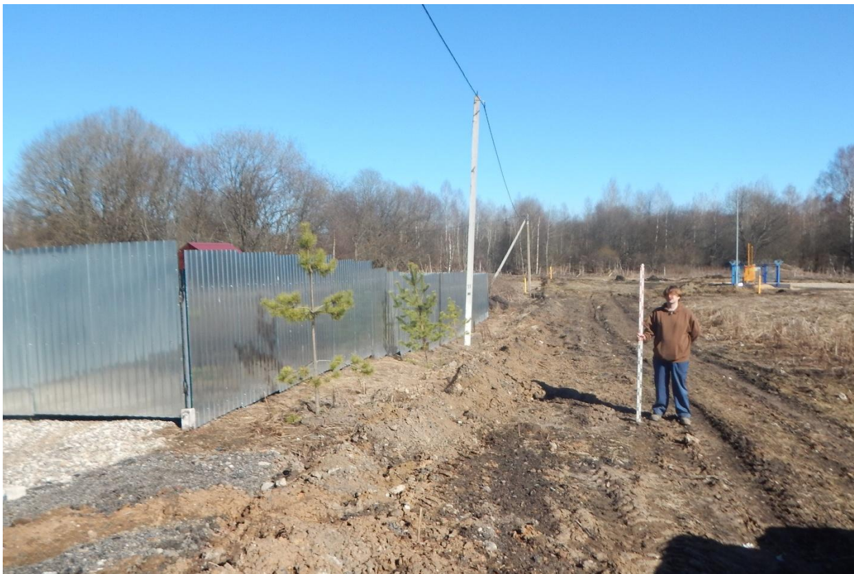
Рис. 213. Ивановская область, Ивановский район, д. Максаки, распределительный газопровод. Общий вид с запада. Точка фотофиксации 5.
