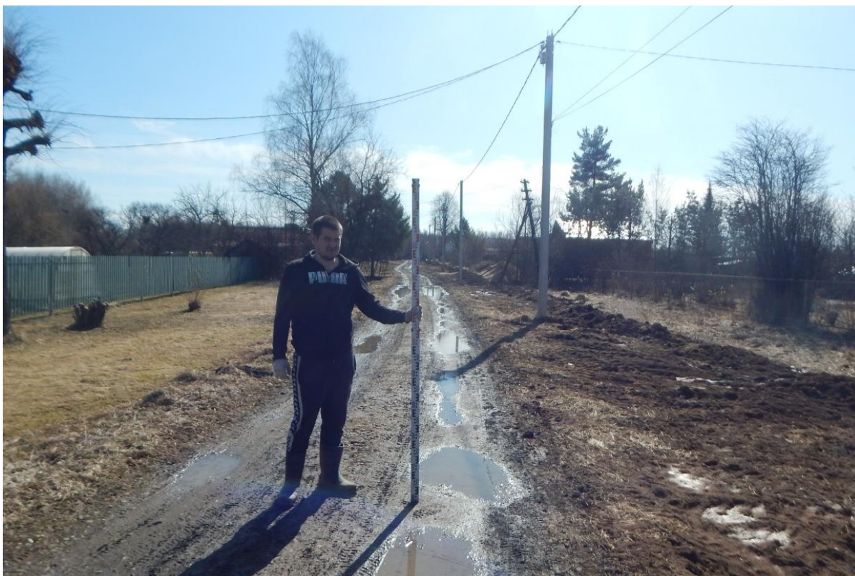
Рис. 68. Ивановская область, Ивановский район, с. Озёрный, распределительный газопровод. Общий вид с севера. Точка фотофиксации 14.
