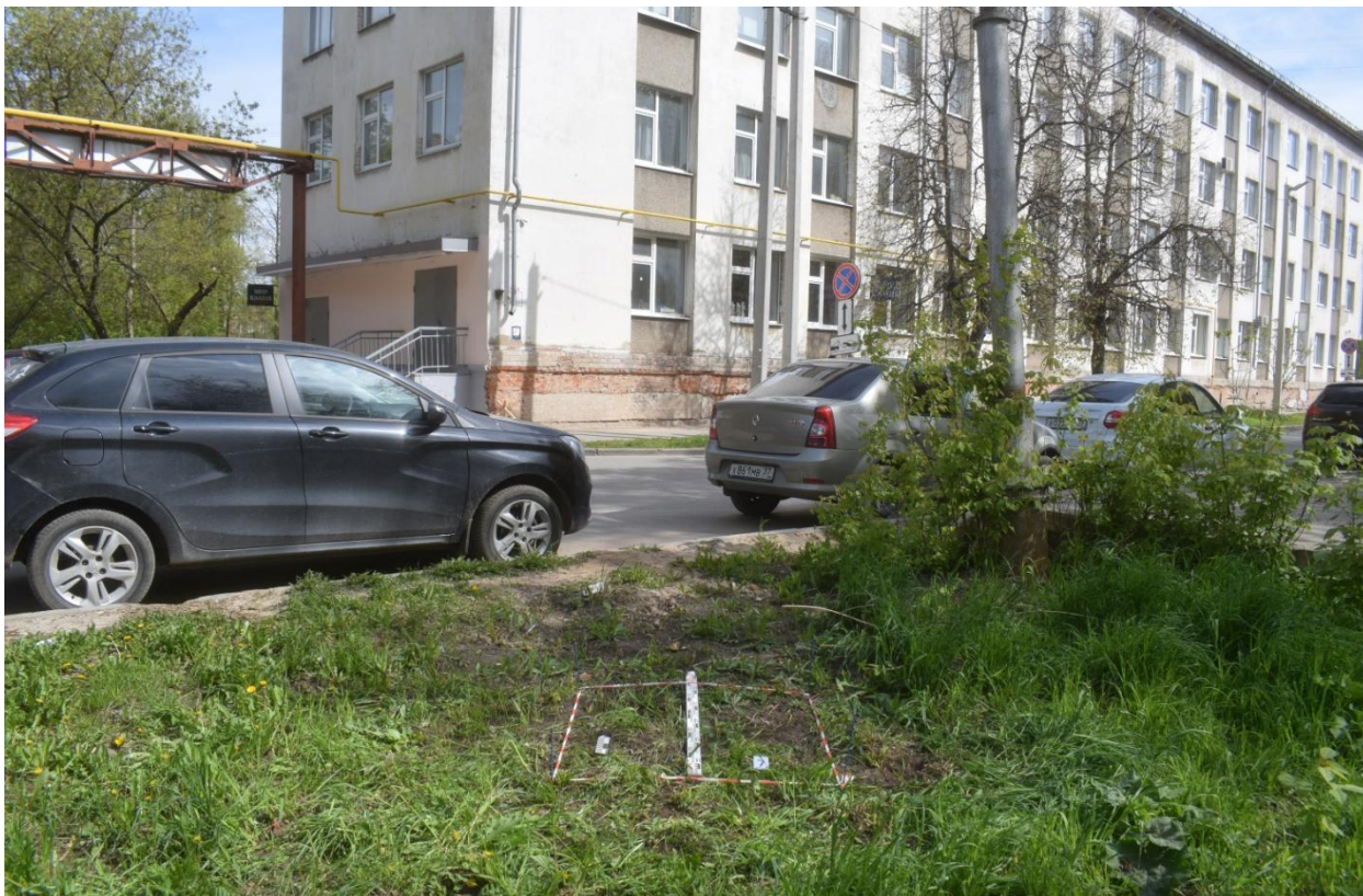
Рис. 53. Ивановская область, г. Иваново, линейный объект под размещение УДС. Шурф № 7, разметка и общий вид с юга.
