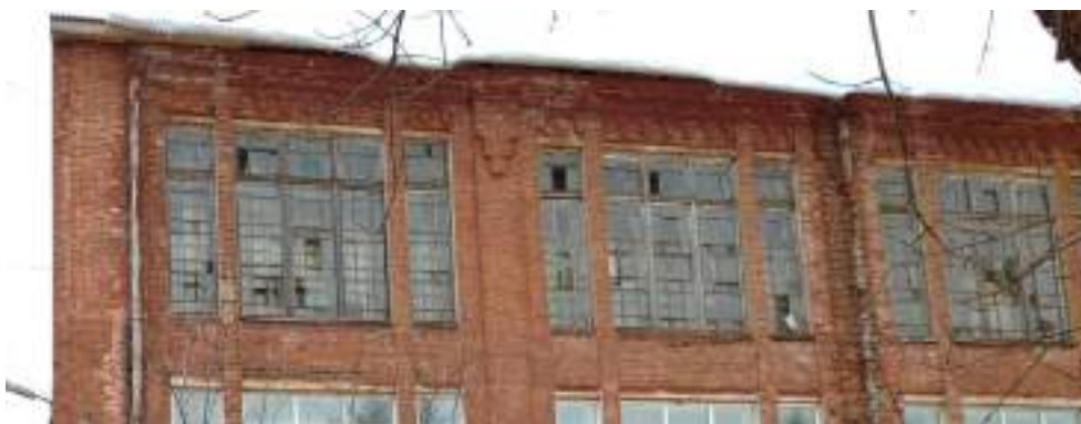
Рис. 91. Расстекловка окон 3-го этажа ситцепечатной фабрики.
