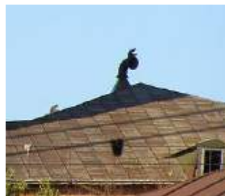
Рис. 15, 16. Прядильный корпус. Утраченные гринельная башня и дымник
