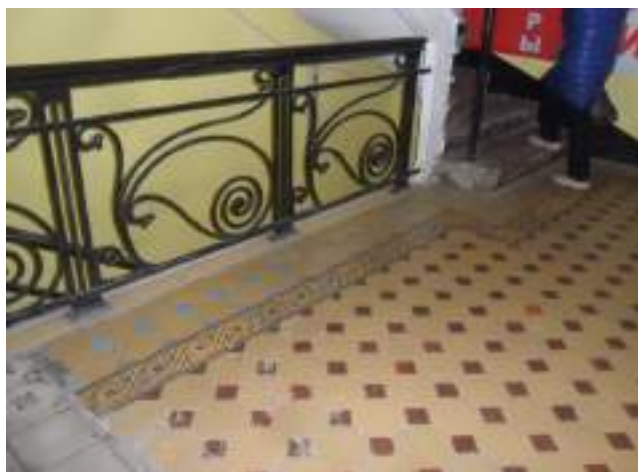
Фото 45. Дом № 5. Лестничная клетка на 1 этаже. Пол, ограждение спуска в подвал
