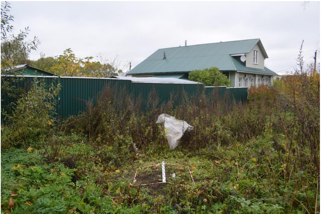
Рис. 11. Ивановская область, Лежневский район, пос. Лежнево, газификация жилого дома по ул. Октябрьской, 4. Разведочный шурф, разметка и общий вид с юга.
