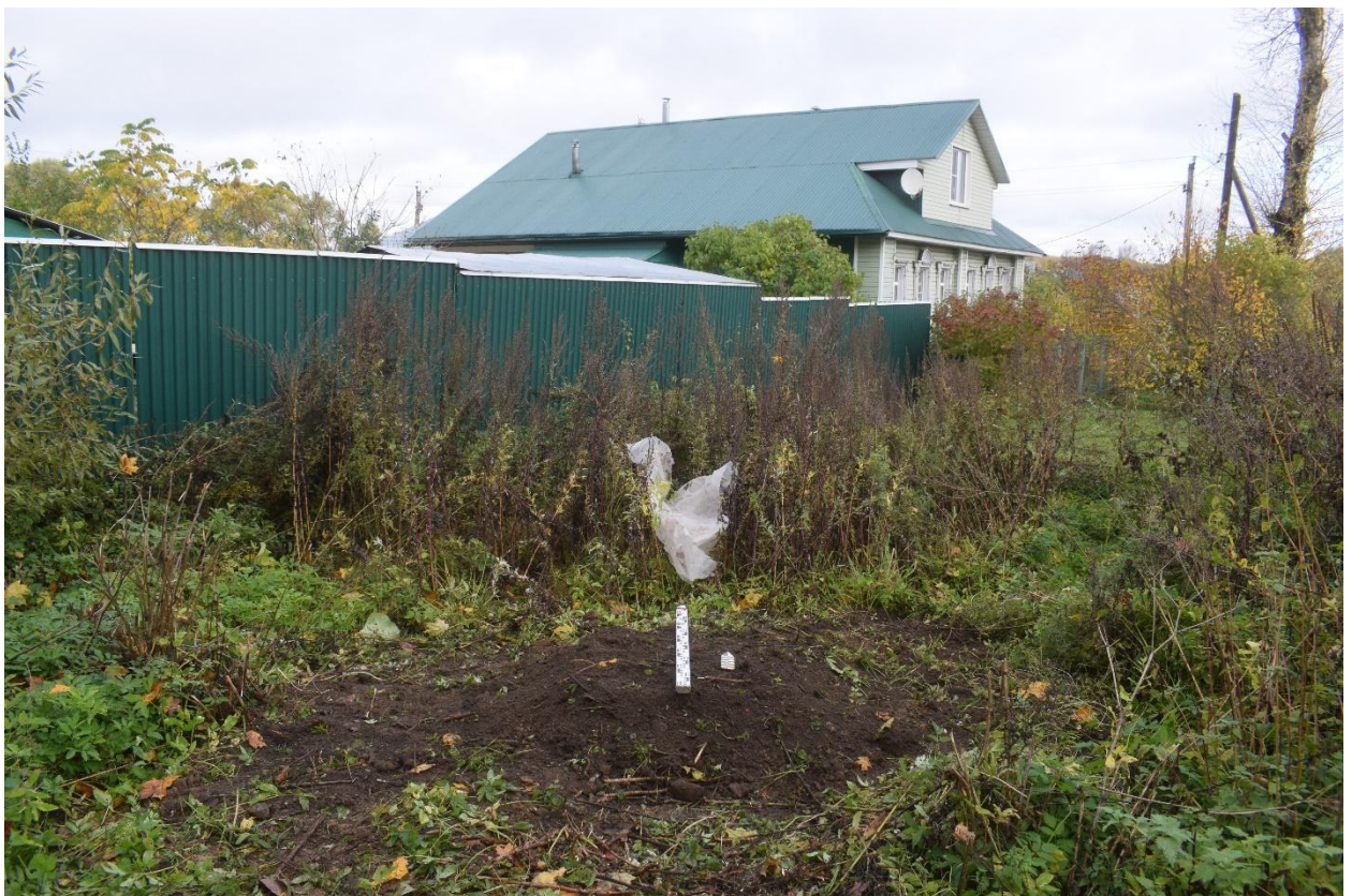
Рис. 14. Ивановская область, Лежневский район, пос. Лежнево, газификация жилого дома по ул. Октябрьской, 4. Разведочный шурф, рекультивация, вид с юга.
