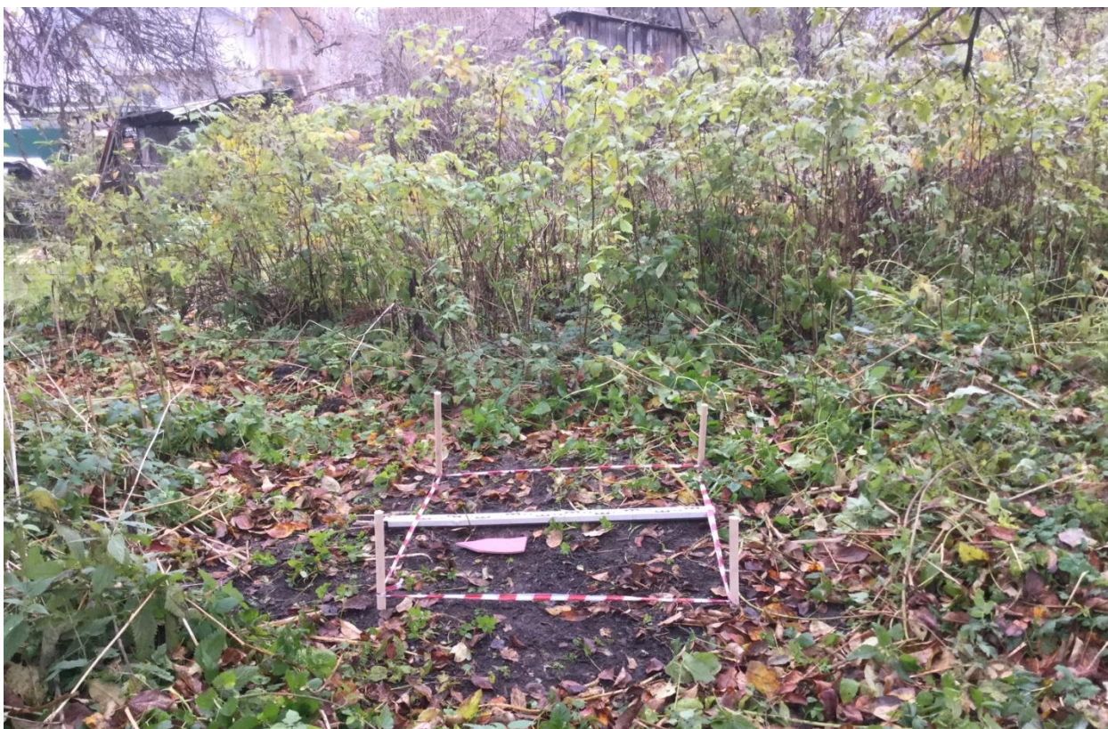
Рис. 16. Ивановская обл., г. Плѣс, ул. Советская, 71. Разведочный шурф, разметка и общий вид с запада.
