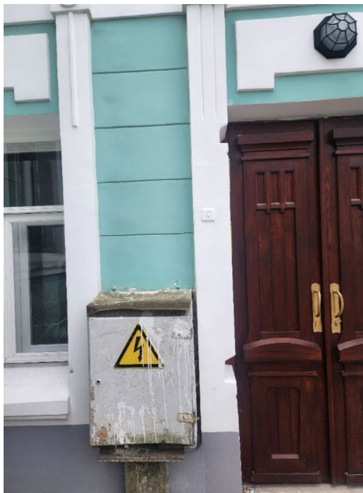
Фотография 5 – Вид на существующее щитовое оборудование. Восточная сторона.
