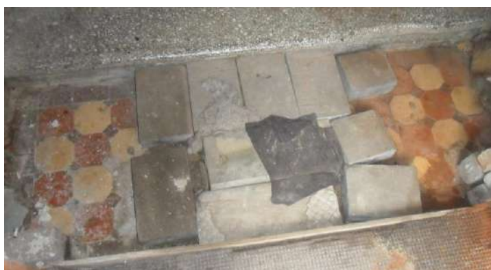
Фото 29. Плитка на площадке 1-го этажа парадной лестницы
