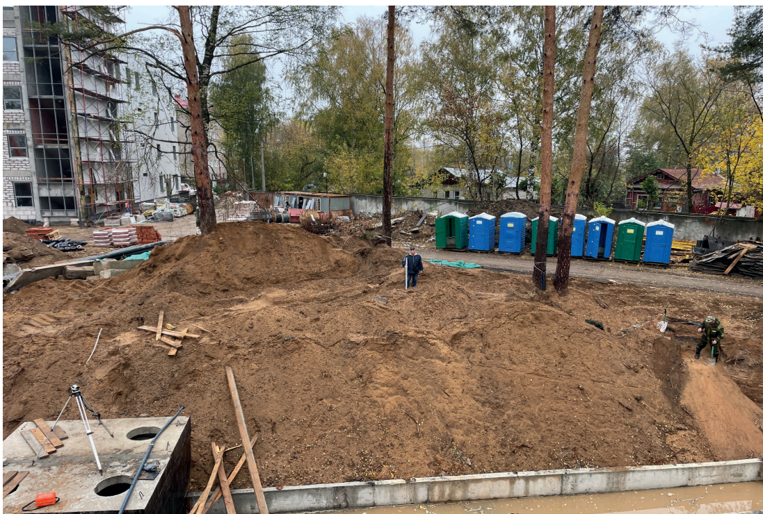
Рис. 15. Объект: «Строительство водогрейной котельной 400Гкал/час на территории Ивановской ТЭЦ-2», расположенной по адресу: РФ, Ивановская обл., г. Иваново, ул. Суворова, 76. Вид из тф 1 на С3.
