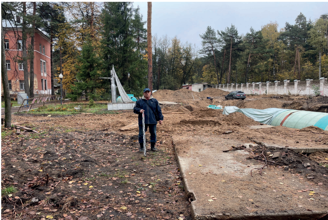
Рис. 28. Объект: «Строительство водогрейной котельной 400Гкал/час на территории Ивановской ТЭЦ-2», расположенной по адресу: РФ, Ивановская обл., г. Иваново, ул. Суворова, 76. Вид с 3 на разбивку шурфа 3.
