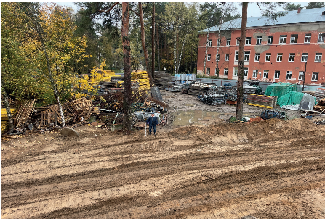
Рис. 17. Объект: «Строительство водогрейной котельной 400Гкал/час на территории Ивановской ТЭЦ-2», расположенной по адресу: РФ, Ивановская обл., г. Иваново, ул. Суворова, 76. Вид из тф 1 на В.
