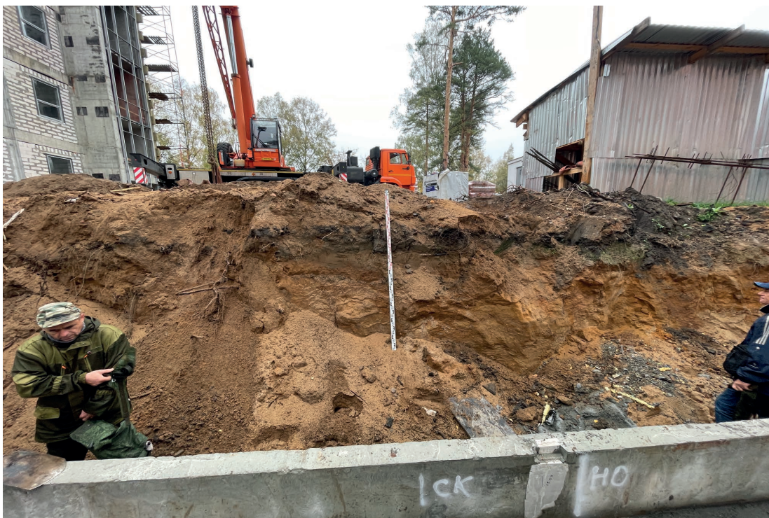
Рис. 33. Объект: «Строительство водогрейной котельной 400Гкал/час на территории Ивановской ТЭЦ-2», расположенной по адресу: РФ, Ивановская обл., г. Иваново, ул. Суворова, 76. Вид с Ю на место зачистки 1.
