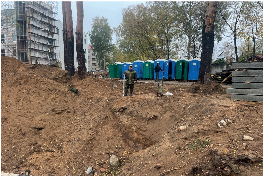
Рис. 20. Объект: «Строительство водогрейной котельной 400Гкал/час на территории Ивановской ТЭЦ-2», расположенной по адресу: РФ, Ивановская обл., г. Иваново, ул. Суворова, 76. Вид с В на разбивку шурфа 1.
