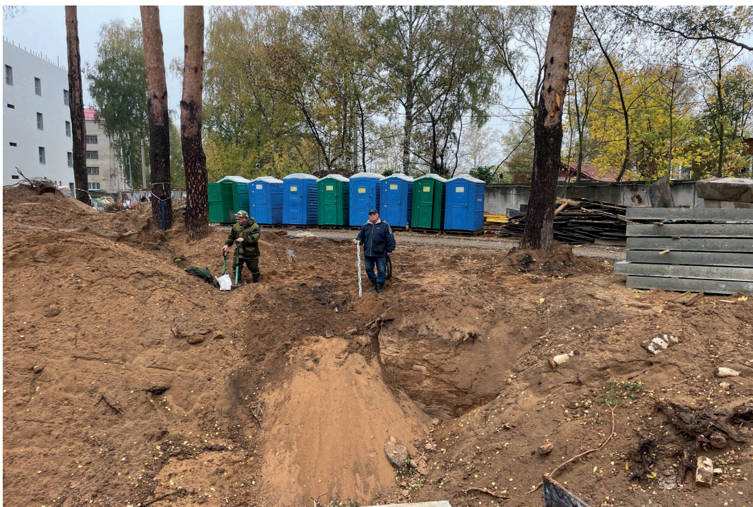
Рис. 23. Объект: «Строительство водогрейной котельной 400Гкал/час на территории Ивановской ТЭЦ-2», расположенной по адресу: РФ, Ивановская обл., г. Иваново, ул. Суворова, 76. Вид с В на рекультивацию шурфа 1.
