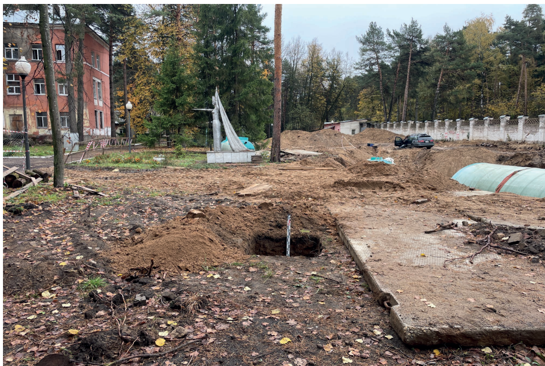
Рис. 31. Объект: «Строительство водогрейной котельной 400Гкал/час на территории Ивановской ТЭЦ-2», расположенной по адресу: РФ, Ивановская обл., г. Иваново, ул. Суворова, 76. Общий вид с 3 на шурф 3.
