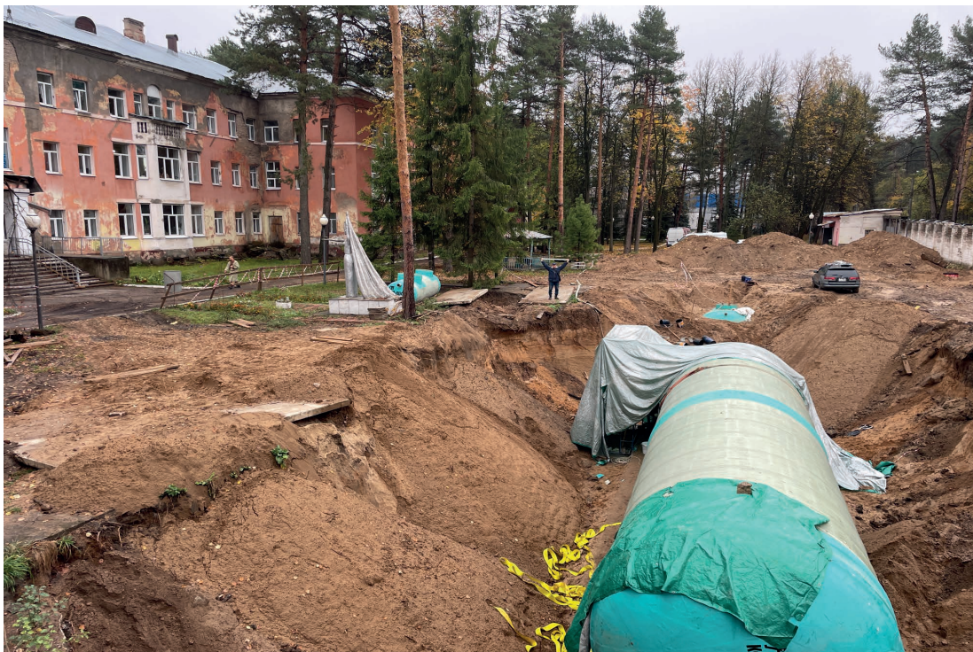
Рис. 18. Объект: «Строительство водогрейной котельной 400Гкал/час на территории Ивановской ТЭЦ-2», расположенной по адресу: РФ, Ивановская обл., г. Иваново, ул. Суворова, 76. Вид из тф 2 на В.
