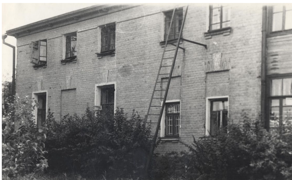
Рис. 5. Фото боковых фасадов в 1971 г. из архива Комитета Ивановской области по государственной охране объектов культурного наследия
