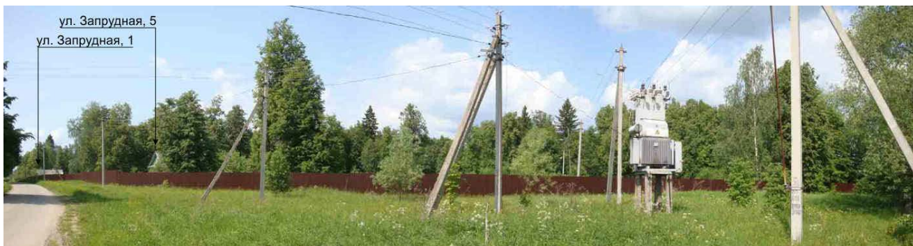
Фото 68. Трансформаторная подстанция и ограждение из профлиста. Вид с дамбы пруда. Фото 2019 г.
