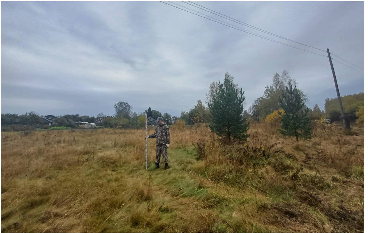
Рис. 175. Ивановская обл., Лухский р-н, распределительный газопровод д. Сорокино. Общий вид участка газопровода с северо-северо-востока (точка фотофиксации 6).
