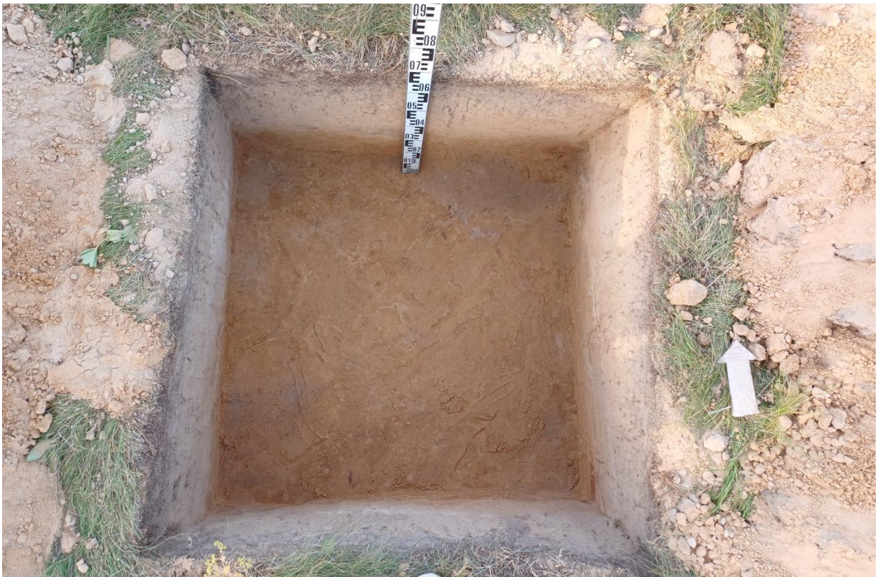
Рис. 65. Ивановская обл., Лухский р-н, распределительный газопровод с. Благовещенье. Шурф № 5, зачистка поверхности материка, вид с юга.
