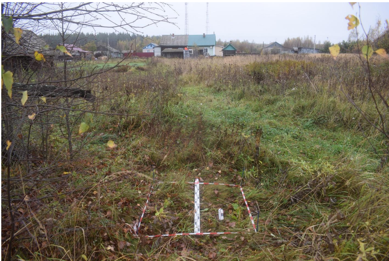
Рис. 84. Ивановская обл., Лухский р-н, распределительный газопровод д. Мясниково. Шурф № 2, разметка и общий вид с юга.
