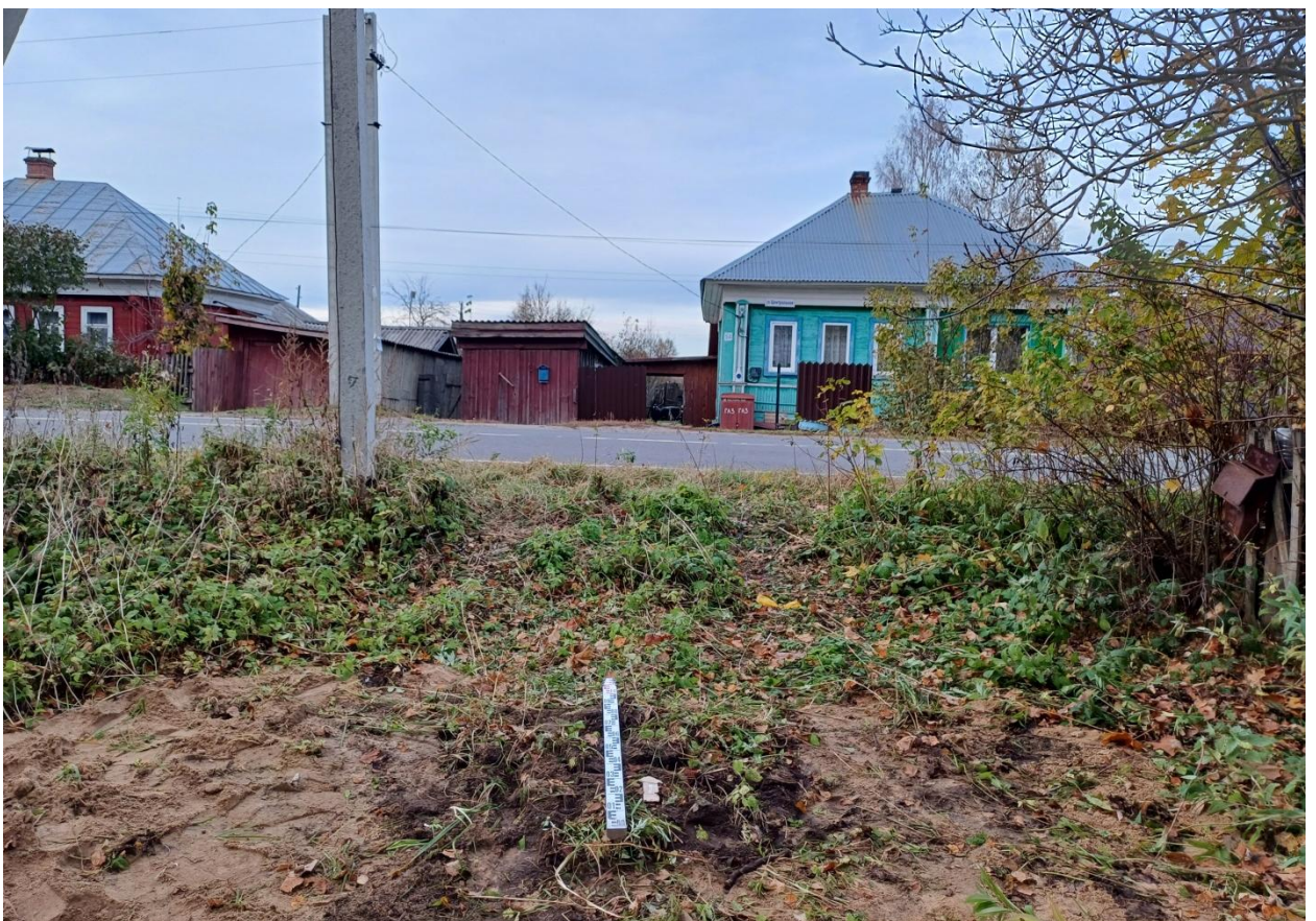
Рис. 102. Ивановская обл., Лухский р-н, распределительный газопровод д. Мясниково. Шурф № 4, рекультивация, вид с юга.
