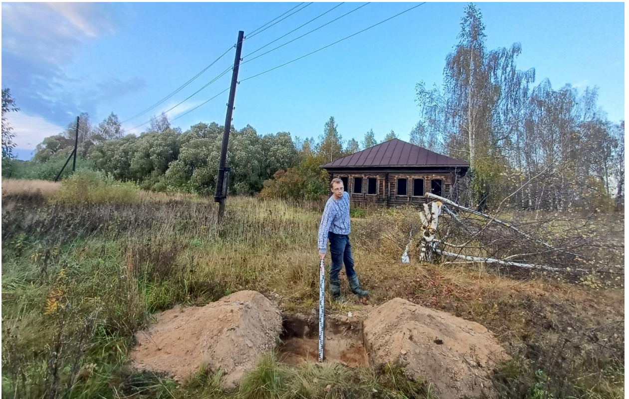
Рис. 159. Ивановская обл., Лухский р-н, распределительный газопровод д. Сорокино. Общий вид с юга выкопанного шурфа № 3.
