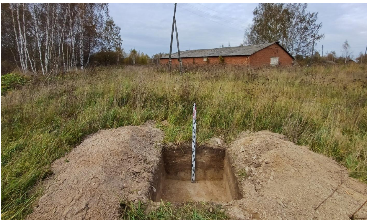
Рис. 166. Ивановская обл., Лухский р-н, распределительный газопровод д. Сорокино. Общий вид с юга выкопанного шурфа № 4.
