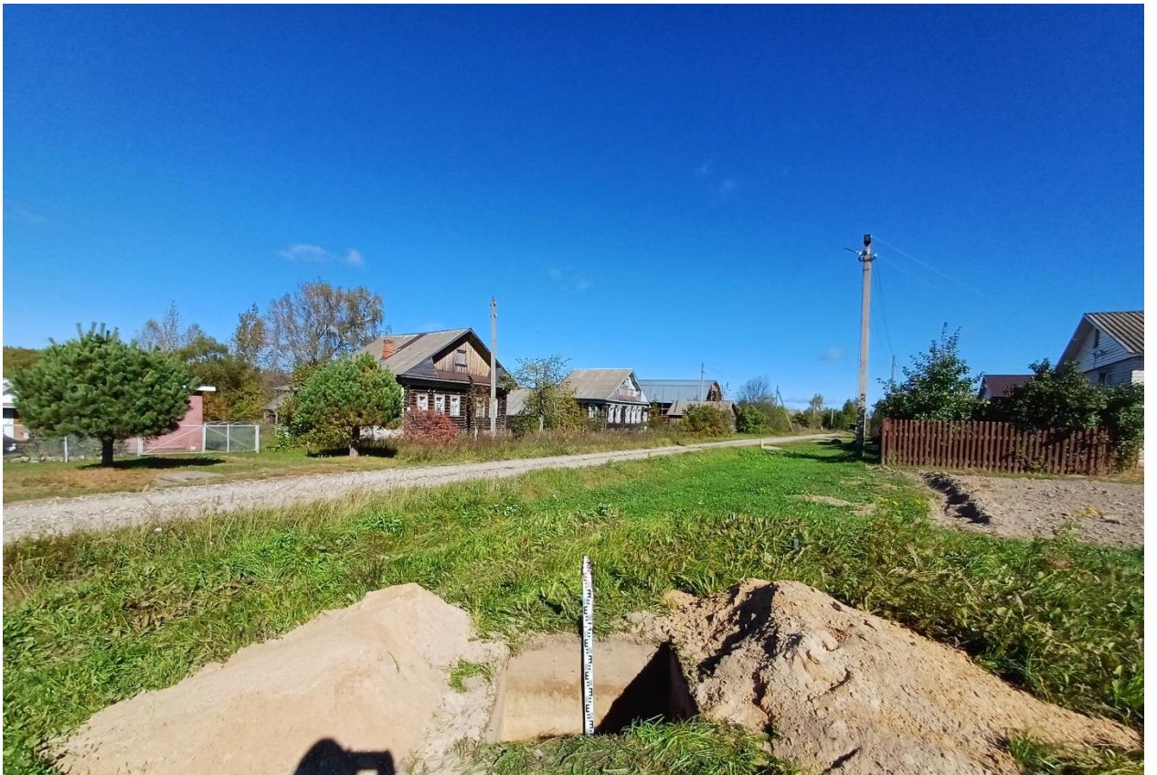
Рис. 46. Ивановская обл., Лухский р-н, распределительный газопровод с. Благовещенье. Общий вид с юга выкопанного шурфа № 2.
