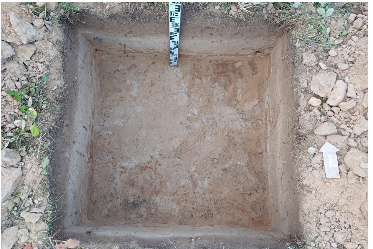
Рис. 92. Ивановская обл., Лухский р-н, распределительный газопровод д. Мясниково. Шурф № 3, зачистка поверхности материка, вид с юга.
