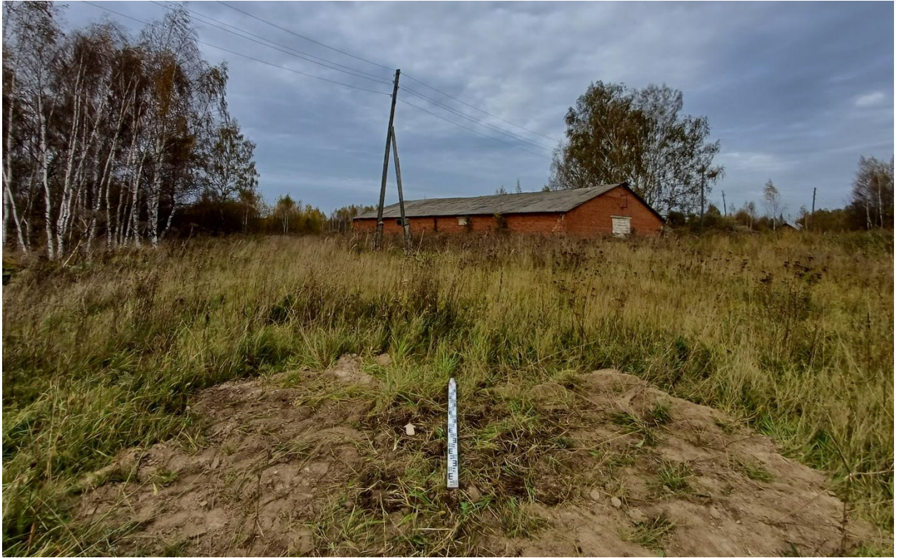
Рис. 167. Ивановская обл., Лухский р-н, распределительный газопровод д. Сорокино. Шурф № 4, рекультивация, вид с юга.
