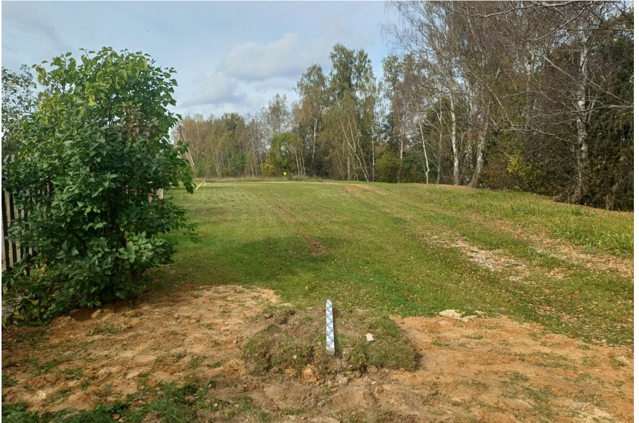
Рис. 14. Ивановская обл., Лухский р-н, распределительный газопровод д. Андреевское. Шурф № 1, рекультивация, вид с юга.
