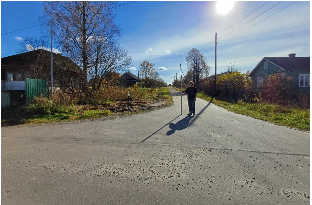
Рис. 122. Ивановская обл., Лухский р-н, распределительный газопровод д. Слободки. Общий вид с востока участка газопровода на ул. Центральная (точка фотофиксации 3).
