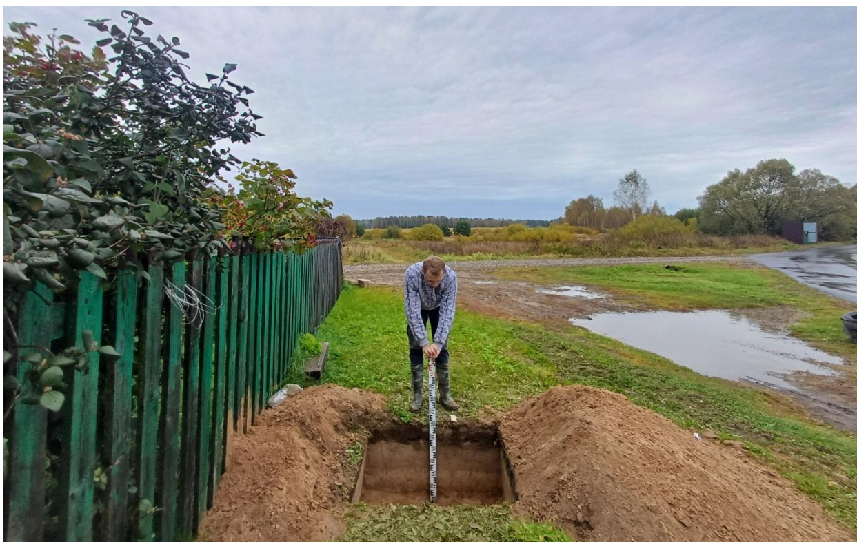
Рис. 146. Ивановская обл., Лухский р-н, распределительный газопровод д. Сорокино. Общий вид с юга выкопанного шурфа № 1.
