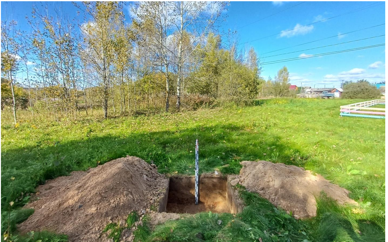
Рис. 60. Ивановская обл., Лухский р-н, распределительный газопровод с. Благовещенье. Общий вид с юга выкопанного шурфа № 4.
