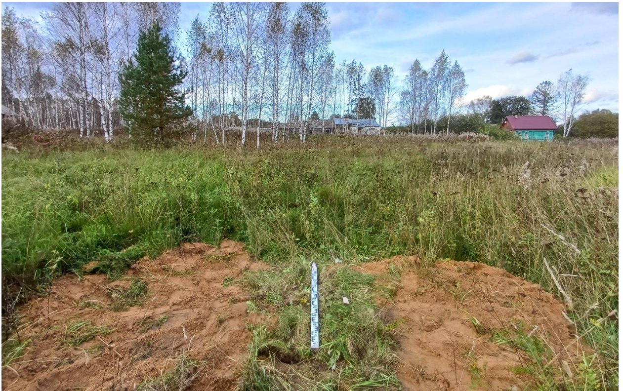
Рис. 27. Ивановская обл., Лухский р-н, распределительный газопровод д. Андреевское. Шурф № 3, рекультивация, вид с юга.
