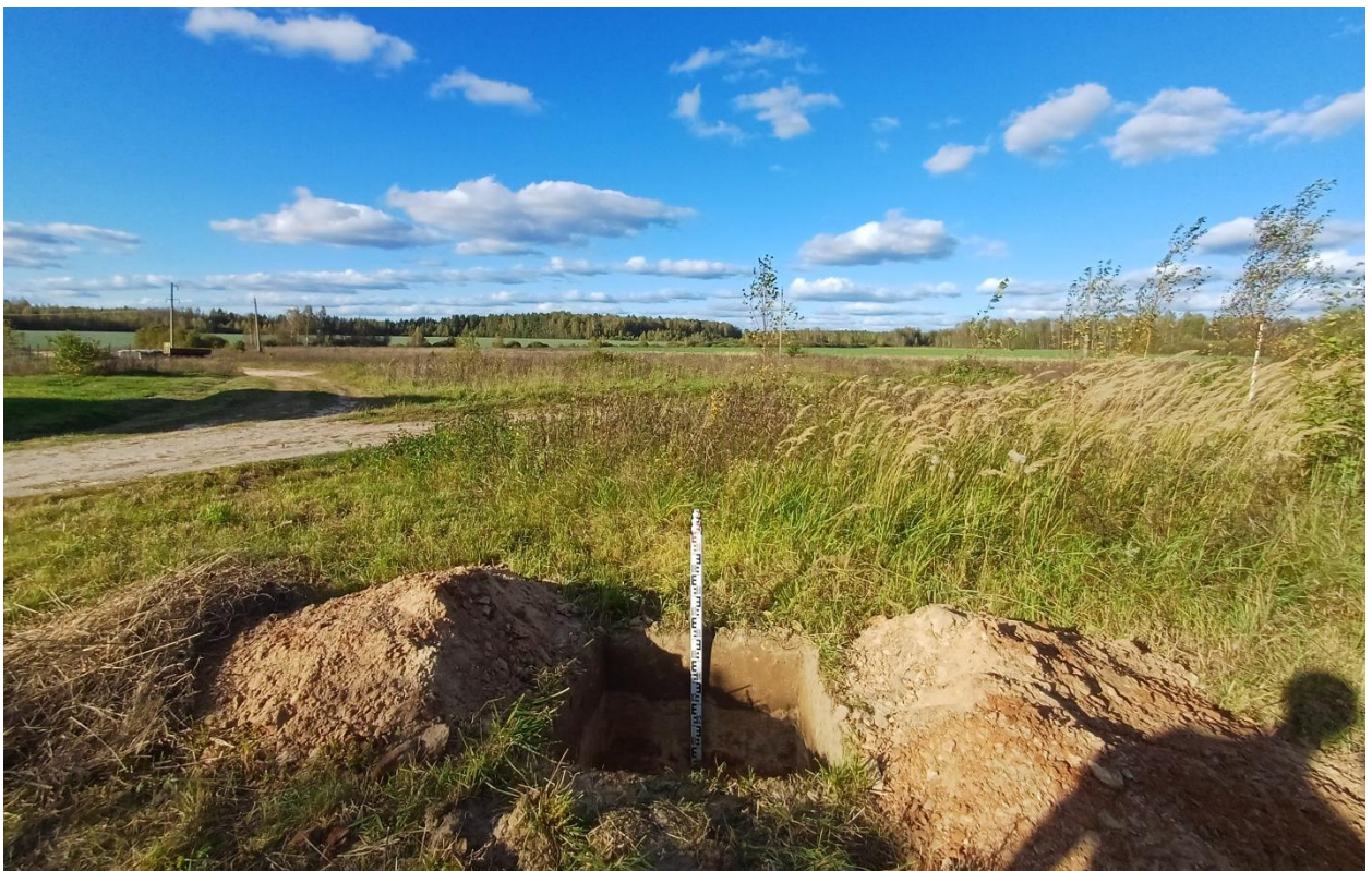
Рис. 53. Ивановская обл., Лухский р-н, распределительный газопровод с. Благовещенье. Общий вид с юга выкопанного шурфа № 3.
