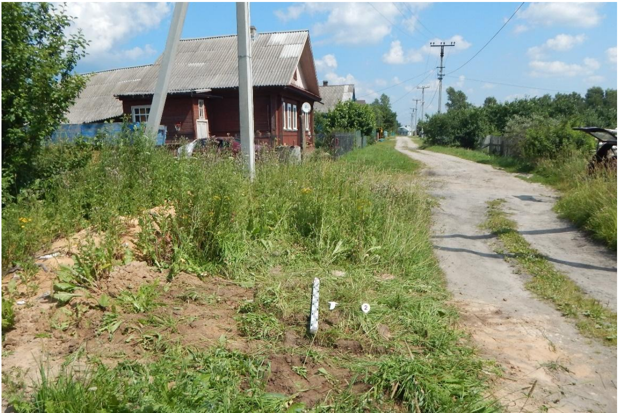
Рис. 50. Ивановская обл., Верхнеландеховский р-н, п.г.т. Верхний Ландех, 2 очередь. Шурф № 2, рекультивация, вид с юга.
