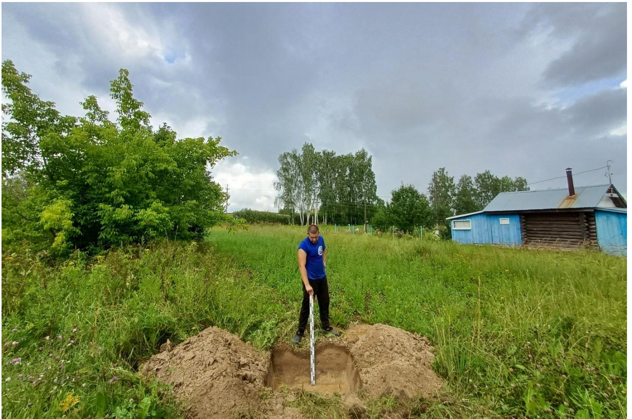
Рис. 144. Ивановская обл., Верхнеландеховский р-н, п.г.т. Верхний Ландех, 2 очередь. Общий вид выкопанного шурфа № 29 с юга.
