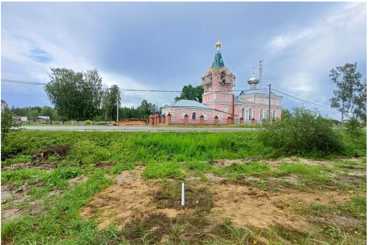
Рис. 139. Ивановская обл., Верхнеландеховский р-н, п.г.т. Верхний Ландех, 2 очередь. Шурф № 28, рекультивация, вид с юга.
