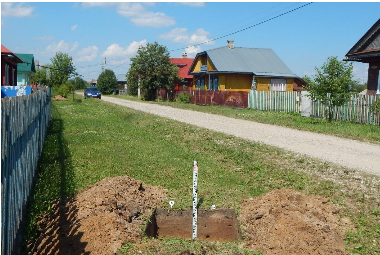
Рис. 67. Ивановская обл., Верхнеландеховский р-н, п.г.т. Верхний Ландех, 2 очередь. Общий вид выкопанного шурфа № 5 с юга.
