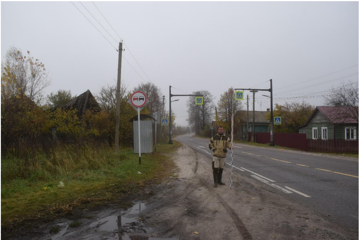
Рис. 22. Ивановская обл., Верхнеландеховский р-н, д. Токарево, распределительный газопровод. Вид с юго-запада на участок прокладки газопровода по первой жилой улице – а/д 24Н-157 (точка фотофиксации 5).
