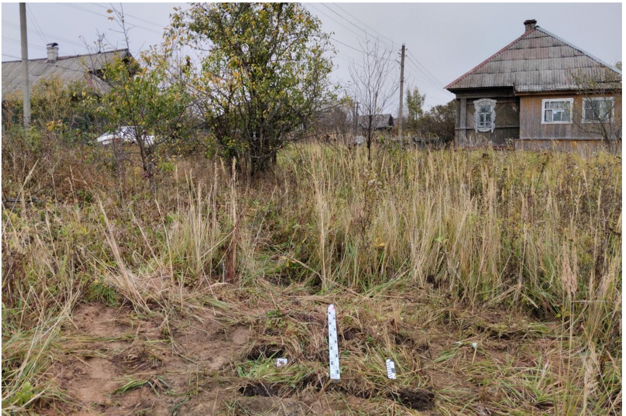
Рис. 43. Ивановская обл., Верхнеландеховский р-н, д. Токарево, распределительный газопровод. Шурф № 4, рекультивация, вид с юга.
