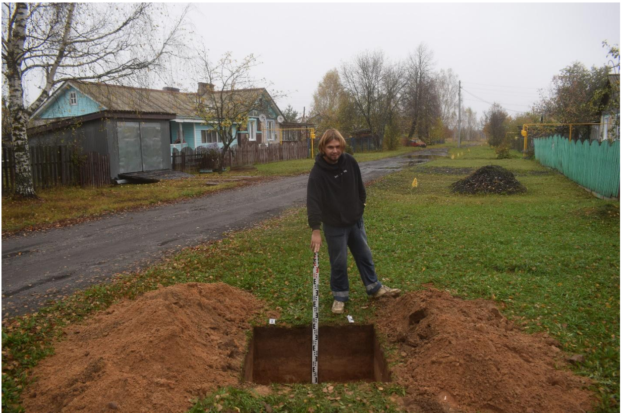
Рис. 27. Ивановская обл., Верхнеландеховский р-н, д. Токарево, распределительный газопровод. Общий вид с юга выкопанного шурфа № 1.
