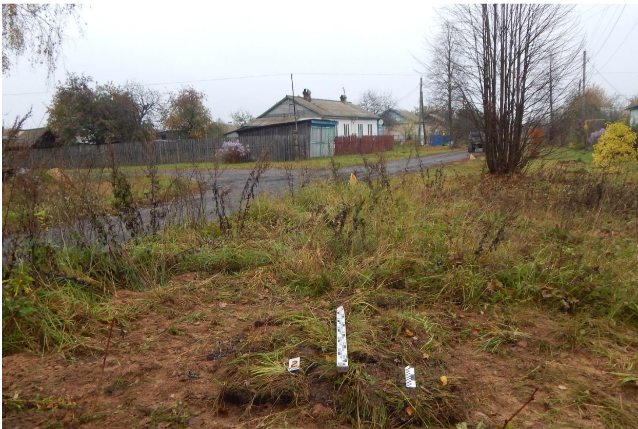
Рис. 33. Ивановская обл., Верхнеландеховский р-н, д. Токарево, распределительный газопровод. Шурф № 2, рекультивация, вид с юга.
