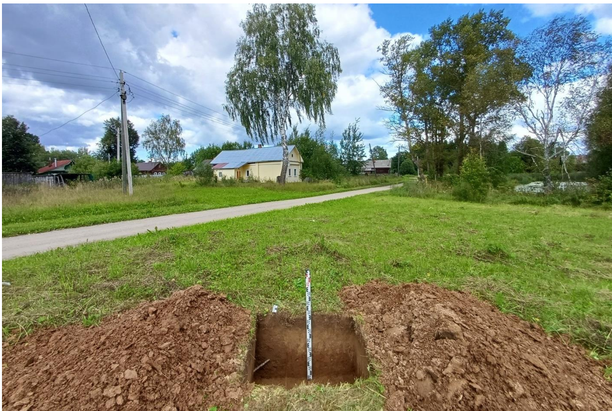
Рис. 84. Ивановская обл., Фурмановский р-н, с. Дуляпино, распределительный газопровод, 2-ая очередь. Общий вид с юга выкопанного шурфа № 2.
