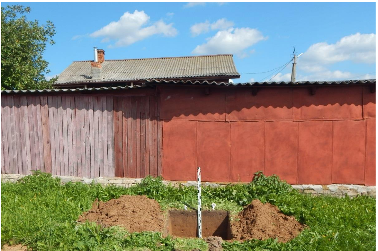
Рис. 202. Ивановская обл., Фурмановский р-н, с. Дуляпино, распределительный газопровод, 2-ая очередь. Общий вид с юга выкопанного шурфа № 20.
