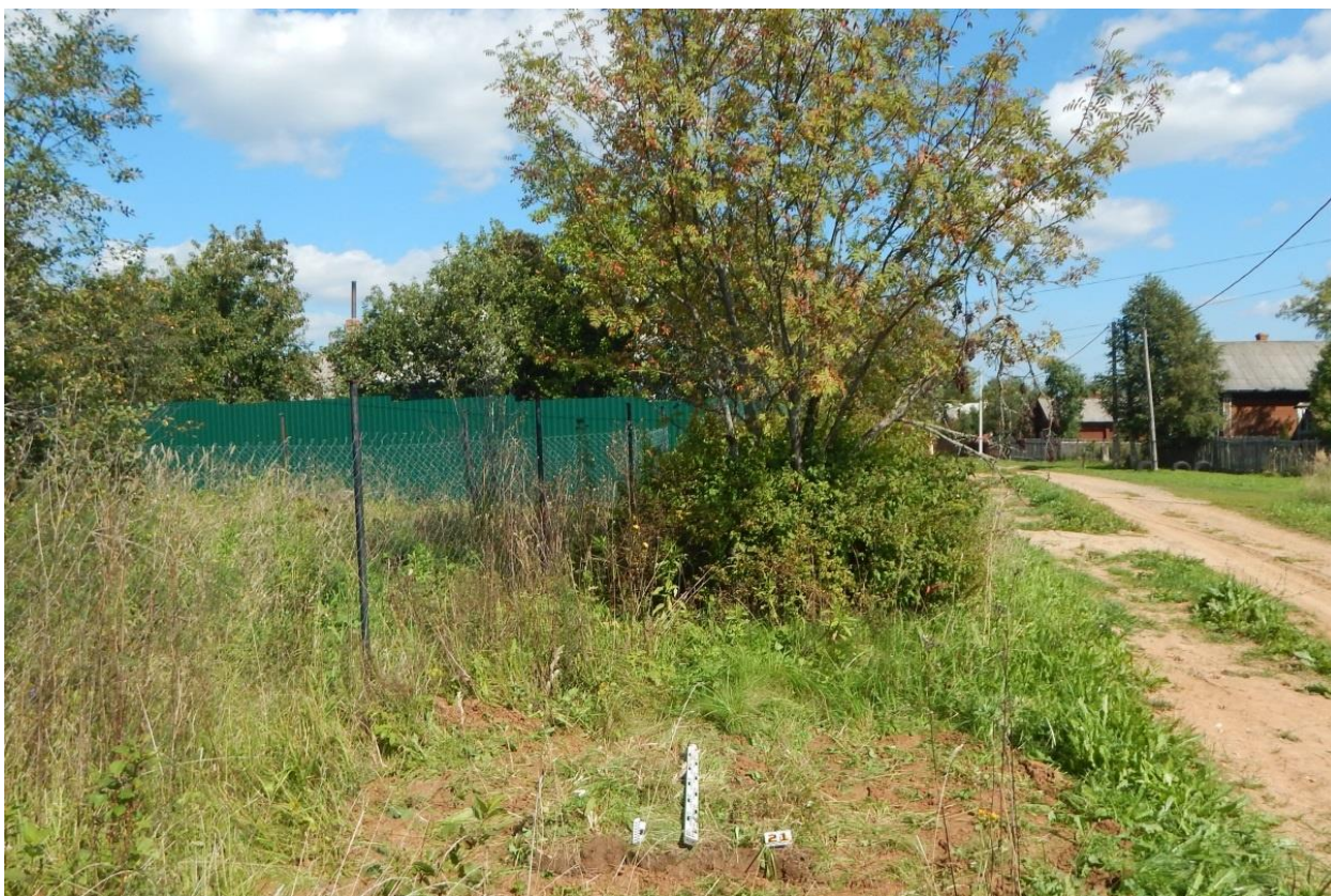
Рис. 209. Ивановская обл., Фурмановский р-н, с. Дуляпино, распределительный газопровод, 2-ая очередь. Шурф № 21, рекультивация, вид с юга.
