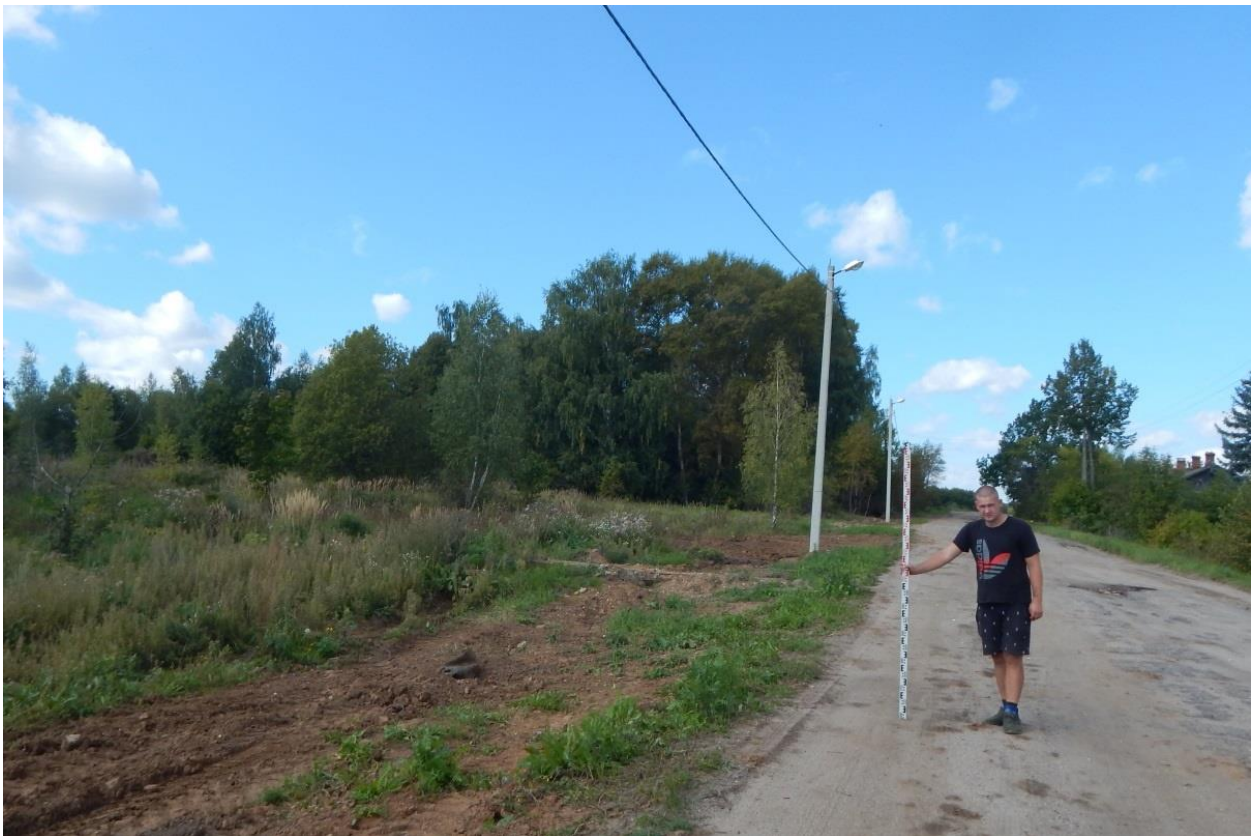
Рис. 160. Ивановская обл., Фурмановский р-н, с. Дуляпино, распределительный газопровод, 2-ая очередь. Точка фотофиксации 14, вид с востока-юго-востока.
