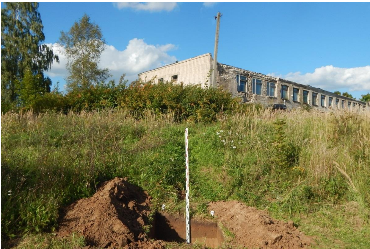
Рис. 176. Ивановская обл., Фурмановский р-н, с. Дуляпино, распределительный газопровод, 2-ая очередь. Общий вид с юга выкопанного шурфа № 16.
