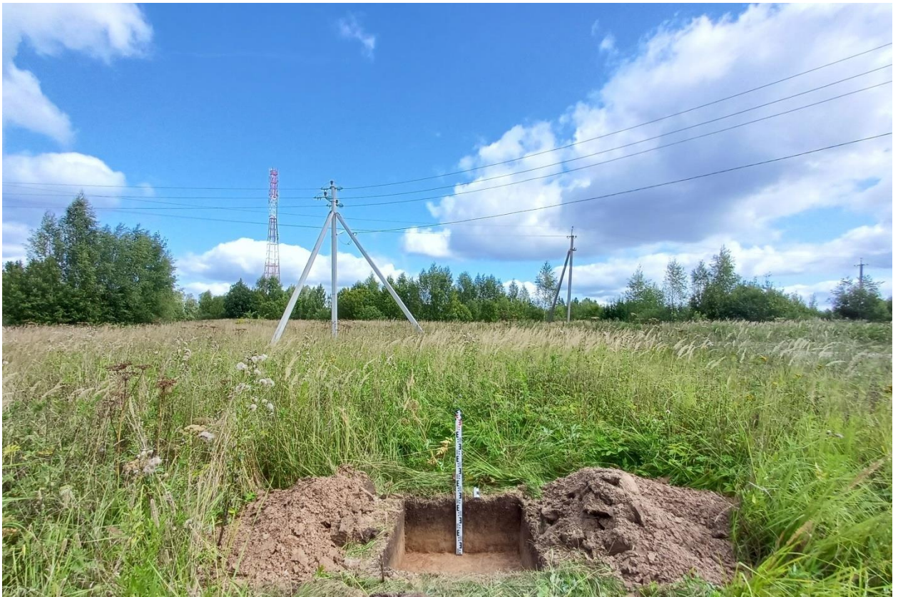
Рис. 103. Ивановская обл., Фурмановский р-н, с. Дуляпино, распределительный газопровод, 2-ая очередь. Общий вид с юга выкопанного шурфа № 5.
