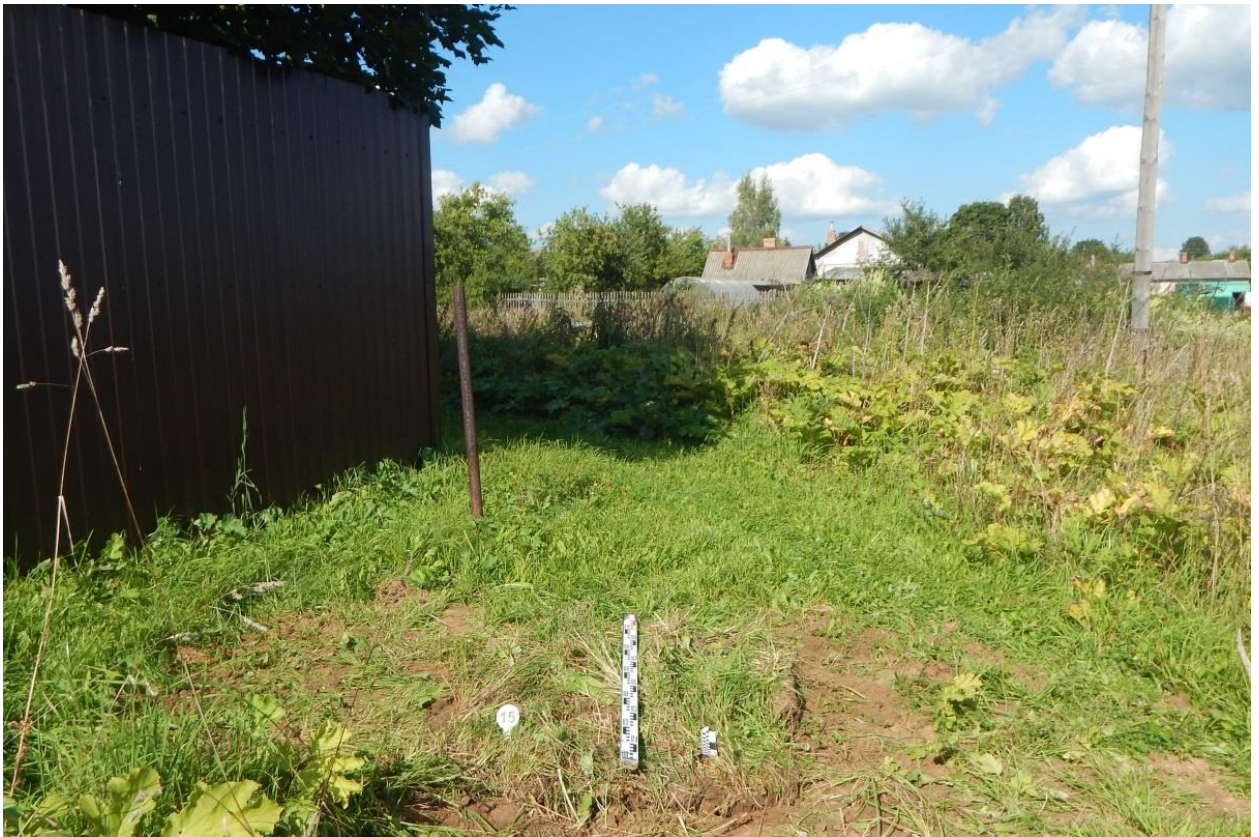
Рис. 171. Ивановская обл., Фурмановский р-н, с. Дуляпино, распределительный газопровод, 2-ая очередь. Шурф № 15, рекультивация, вид с юга.
