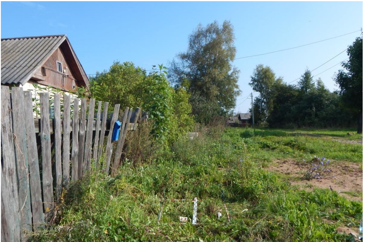
Рис. 247. Ивановская обл., Фурмановский р-н, с. Дуляпино, распределительный газопровод, 2-ая очередь. Шурф № 27, разметка и общий вид с юга.
