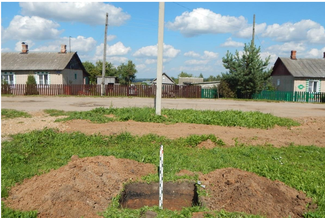
Рис. 164. Ивановская обл., Фурмановский р-н, с. Дуляпино, распределительный газопровод, 2-ая очередь. Общий вид с юга выкопанного шурфа № 14.
