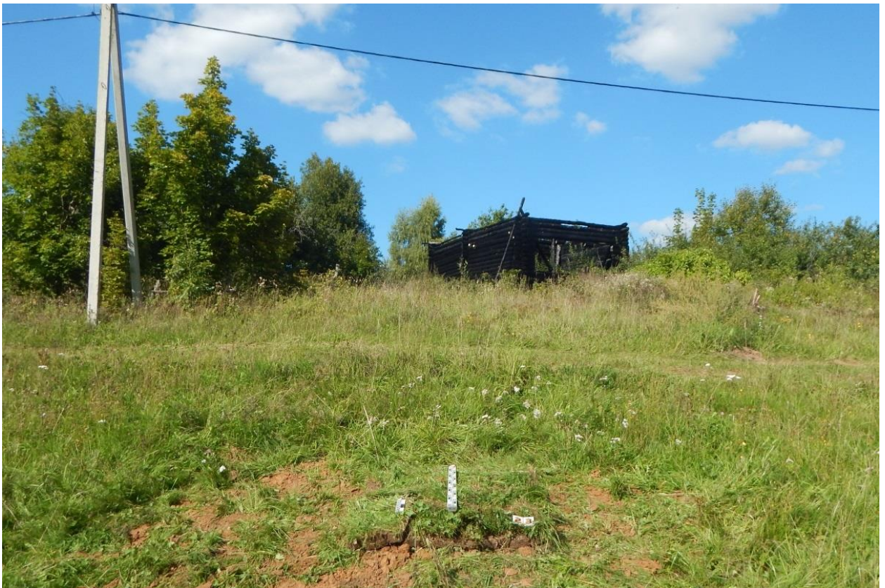
Рис. 224. Ивановская обл., Фурмановский р-н, с. Дуляпино, распределительный газопровод, 2-ая очередь. Шурф № 23, рекультивация, вид с юга.
