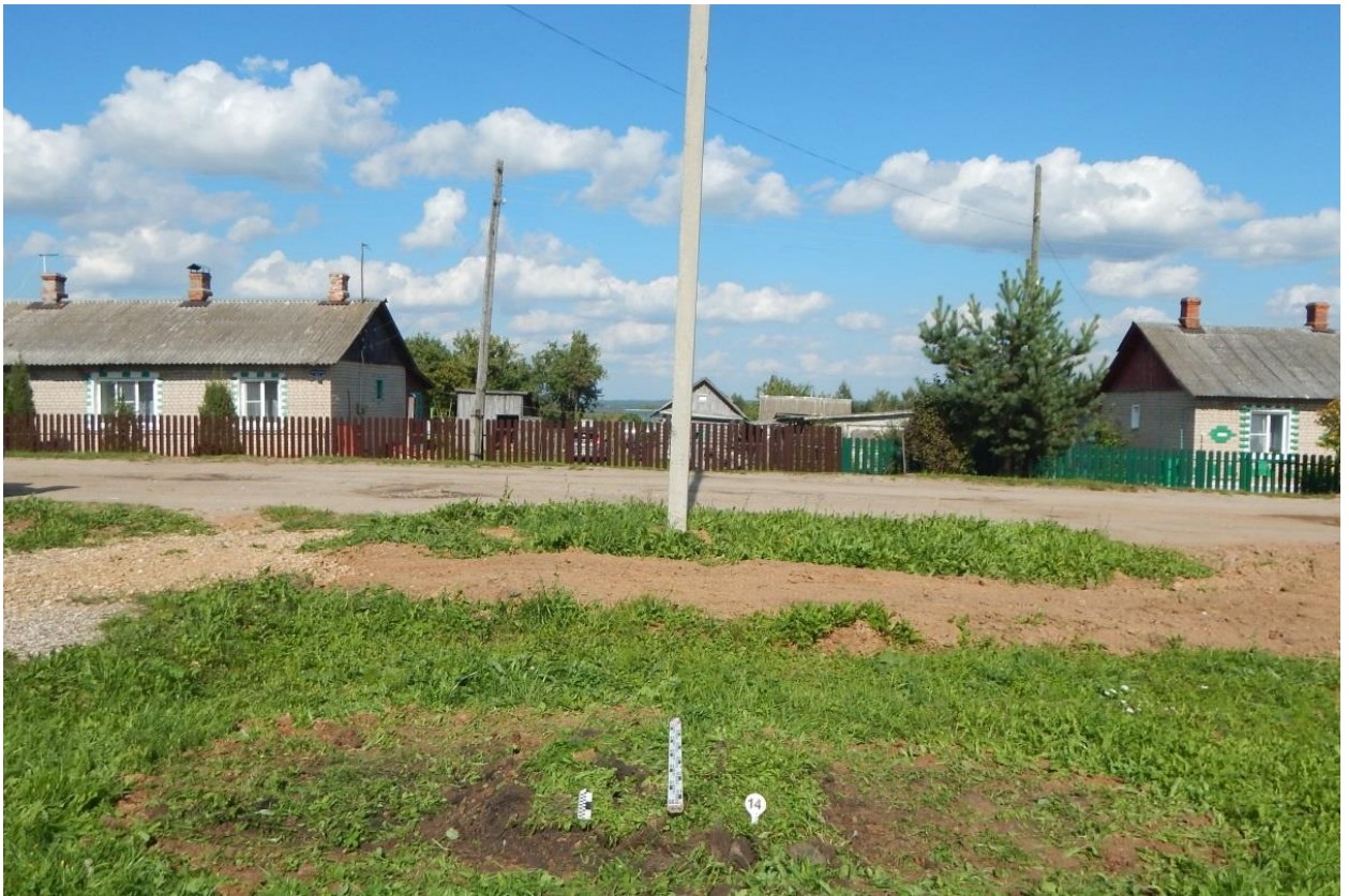
Рис. 165. Ивановская обл., Фурмановский р-н, с. Дуляпино, распределительный газопровод, 2-ая очередь. Шурф № 14, рекультивация, вид с юга.
