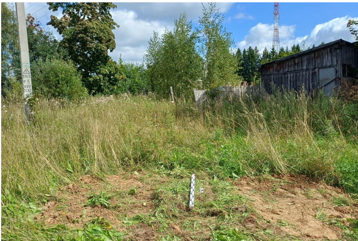
Рис. 97. Ивановская обл., Фурмановский р-н, с. Дуляпино, распределительный газопровод, 2-ая очередь. Шурф № 4, рекультивация, вид с юга.
