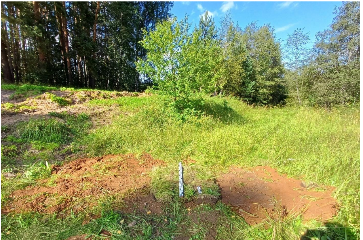
Рис. 78. Ивановская обл., Фурмановский р-н, с. Дуляпино, распределительный газопровод, 2-ая очередь. Шурф № 1, рекультивация, вид с юга.
