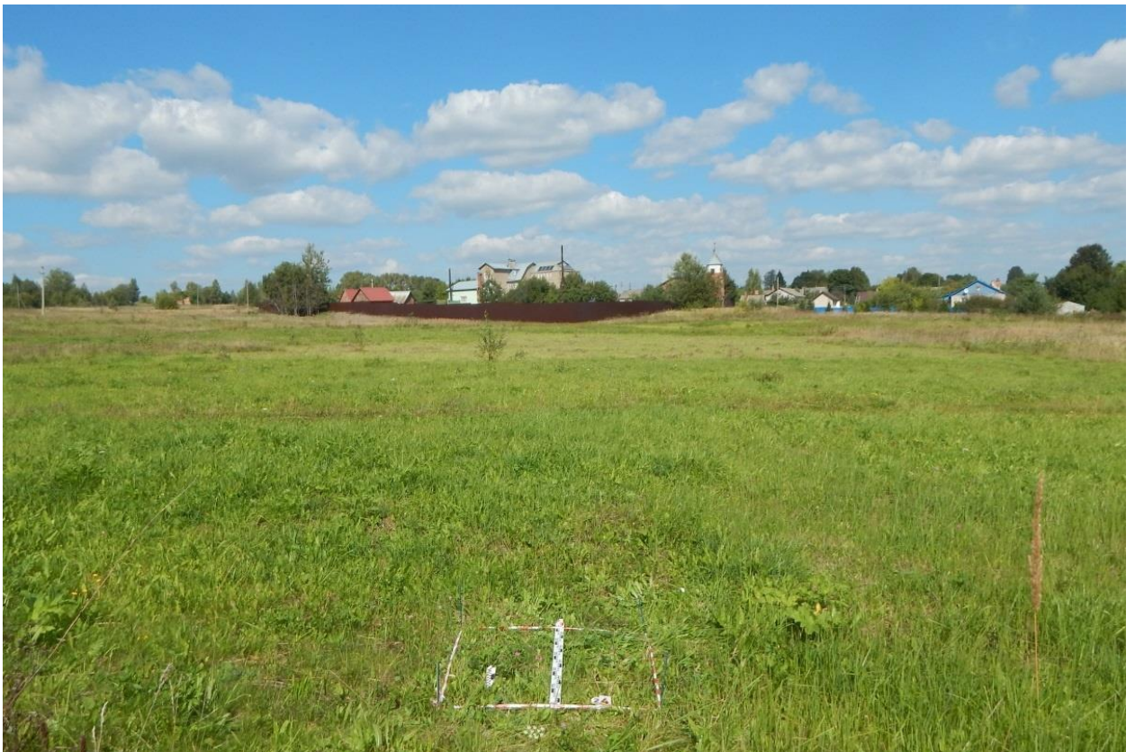
Рис. 226. Ивановская обл., Фурмановский р-н, с. Дуляпино, распределительный газопровод, 2-ая очередь. Шурф № 24, разметка и общий вид с юга.
