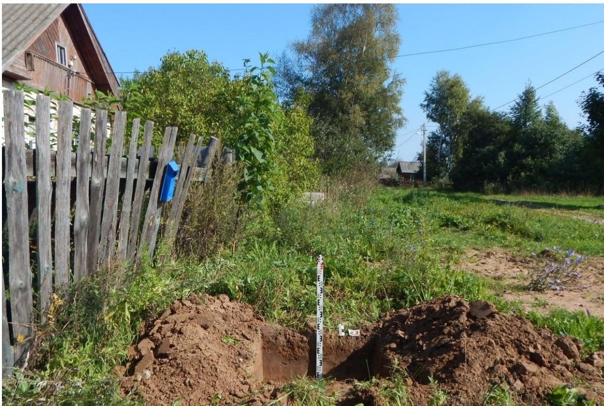
Рис. 250. Ивановская обл., Фурмановский р-н, с. Дуляпино, распределительный газопровод, 2-ая очередь. Общий вид с юга выкопанного шурфа № 27.
