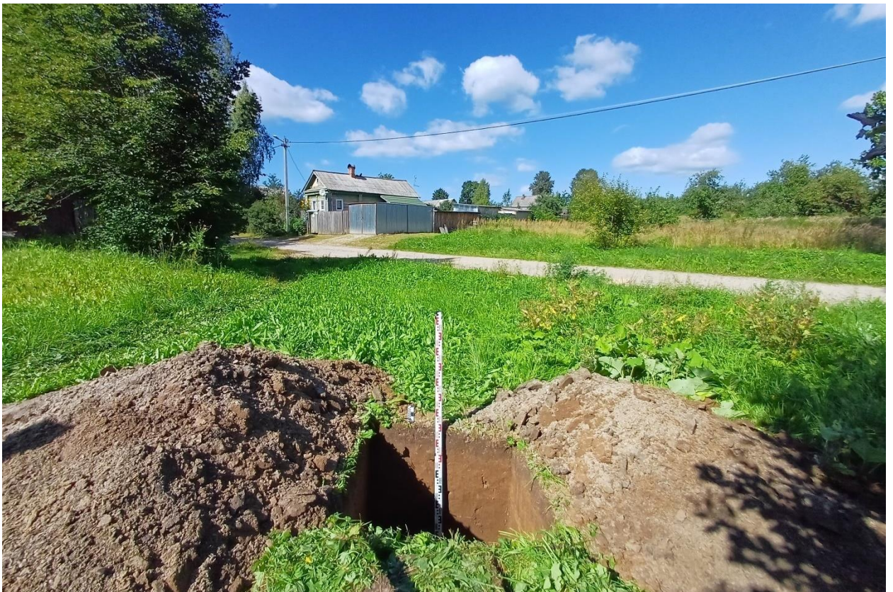
Рис. 124. Ивановская обл., Фурмановский р-н, с. Дуляпино, распределительный газопровод, 2-ая очередь. Общий вид с юга выкопанного шурфа № 8.
