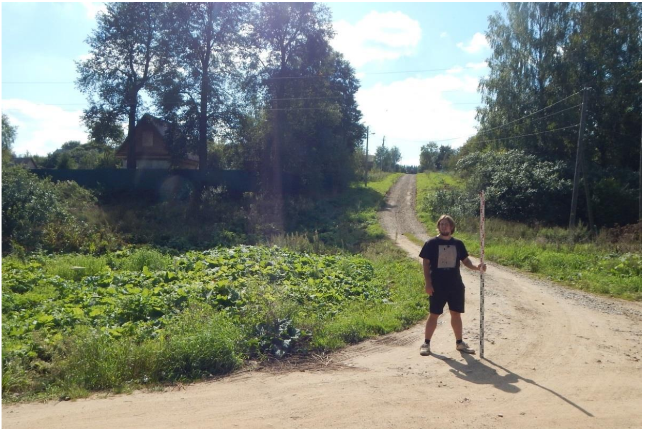
Рис. 219. Ивановская обл., Фурмановский р-н, с. Дуляпино, распределительный газопровод, 2-ая очередь. Точка фотофиксации 23, вид с севера.
